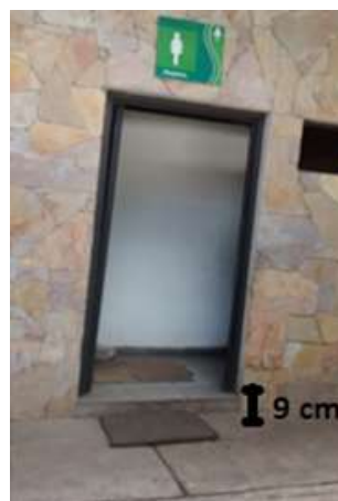
Imagen 3. Baño sin rampa con escalón
