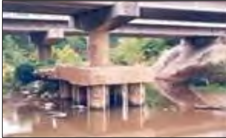
Figura 2.13 Cimentación del puente Maxixapa expuesta debido al fenómeno de socavación local (Martínez, 2017).
