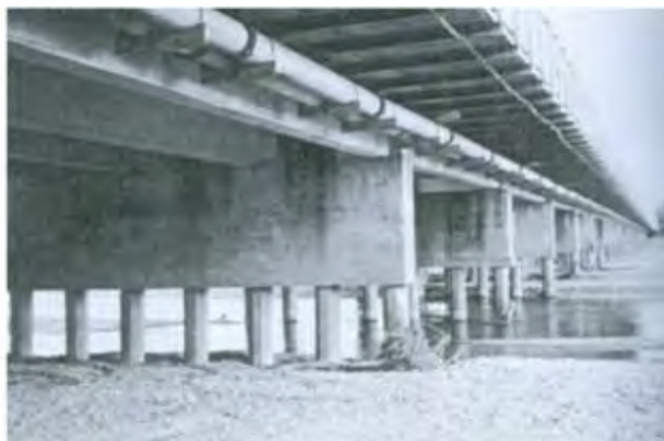
Figura 1.1 Puente Ashburton River, efectos de socavación local en pilas (Tomado de Cusba, 2011).
