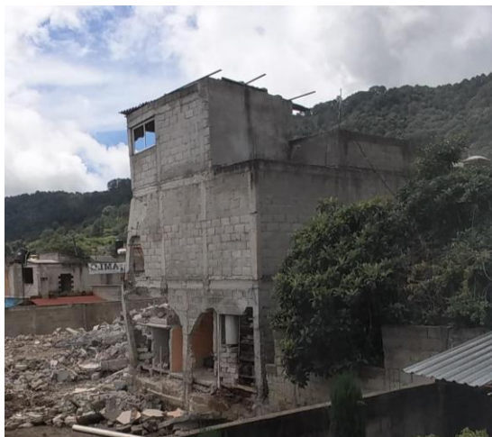
Imagen 5.7. Daños ocasionados por sismo del 19 de septiembre de 2017 en San Miguel Tecomatlán
