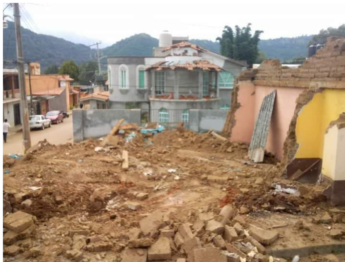
Imagen 5.1. Daños ocasionados por sismo del 19 de septiembre de 2017 en San Miguel Tecomatlán
