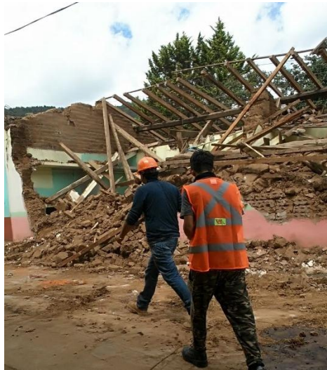
Imagen 5.2. Daños ocasionados por sismo del 19 de septiembre de 2017 en San Miguel Tecamatlán
