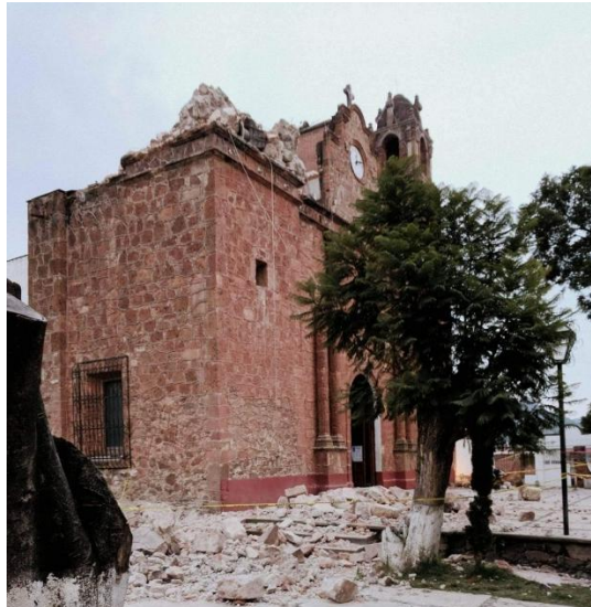
Imagen 5.3. Daños ocasionados por sismo del 19 de septiembre de 2017 en San Miguel Tecamatlán
