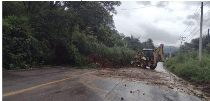
Imagen 5.14. Deslizamiento en carretera Tenancingo-Tenango, a la altura de La Mesita, 29 de septiembre de 2025
