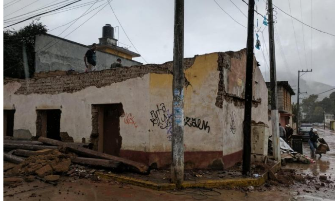
Imagen 5.6. Daños ocasionados por sismo del 19 de septiembre de 2017 en San Miguel Tecamatlán
