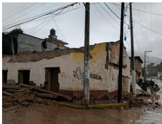
Imagen 5.24. Daños ocasionados por el sismo, 19 de septiembre de 2017 en San Miguel Tecamatlán
