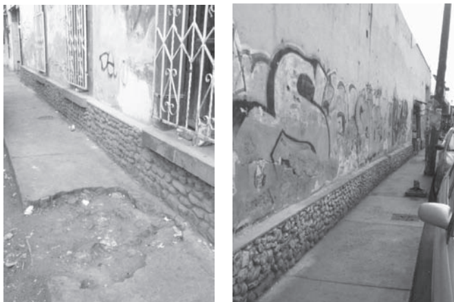
Figura 2. Condiciones deterioradas de la banqueta y obstáculos para transitar en tramo de la calle Jesús Carranza
