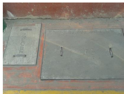
Foto 32. Registros de teléfono y cable subterráneos
