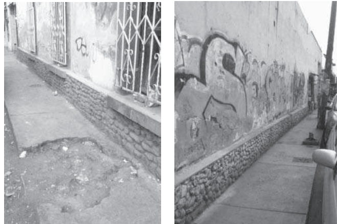
Figura 2. Condiciones deterioradas de la banqueta y obstáculos para transitar en tramo de la calle Jesús Carranza
