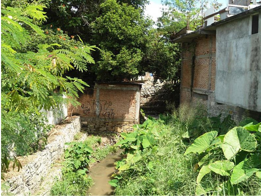
Fotografía 3. Invasión del cauce del arroyo El Arenal, Tuxtla Gutiérrez Chapas.
