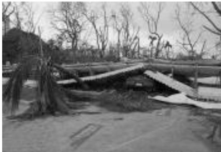
Fotografía 7. Los vientos intensos de un ciclón tropical pueden generar daños estructurales a las edificaciones
