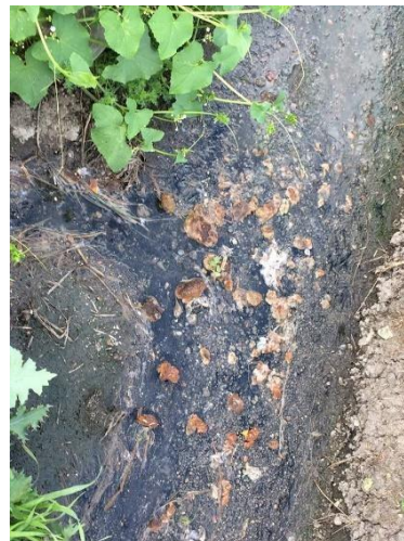
Fotografía 36. Evidencia de drenaje sanitario (Fuente: Obtención en campo)
