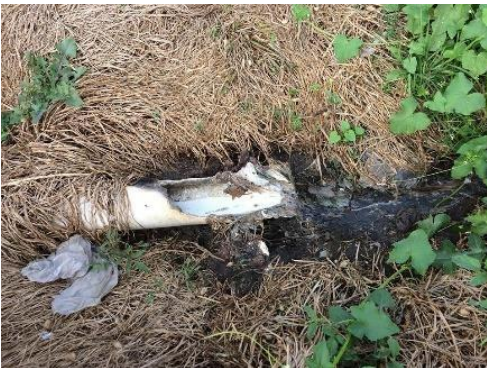
Fotografía 35. Aguas residuales (Fuente: Obtención en campo)
