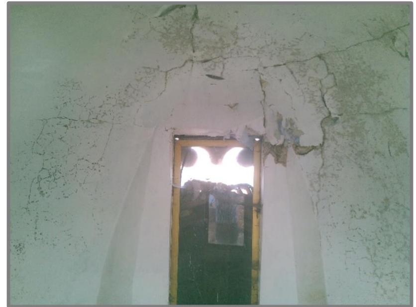
Fotografía 21 Agrietamientos superficiales de la cúpula. Fuente: Autor.
