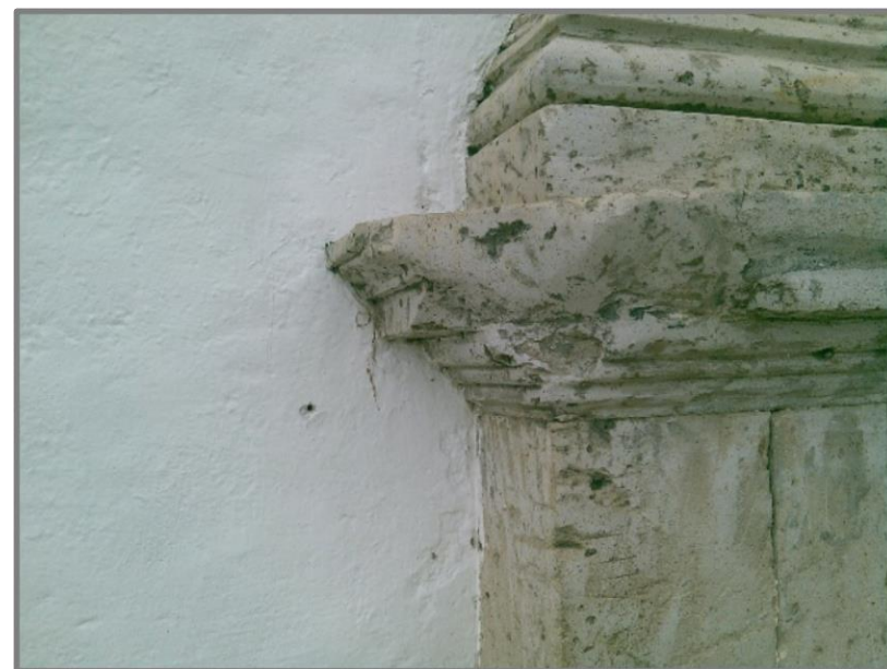
Fotografía 10 Daños en elementos de cantera. Fuente: Autor.
