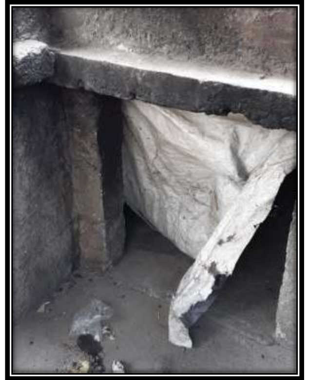
Acceso al temazcal con vinil para evitar la salida del vapor
