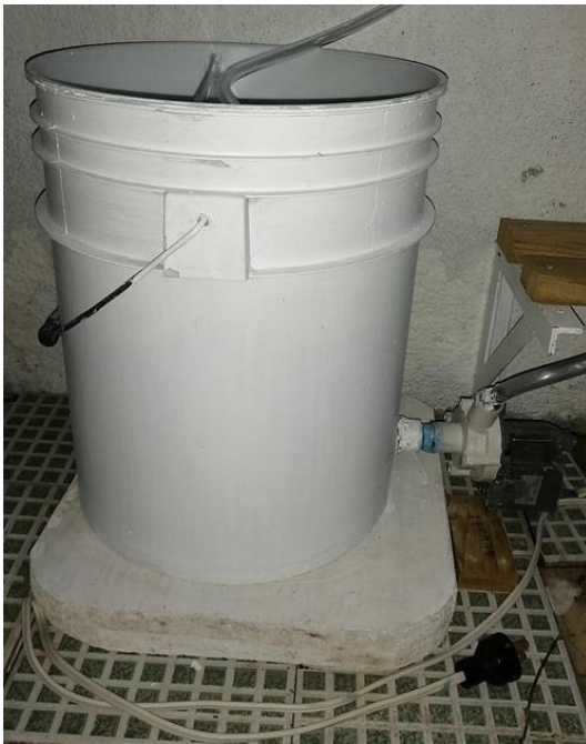
Figura 15. Contenedor y conducto de desagüe trampa de grasas.
