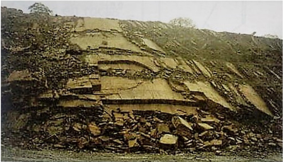
Figura 6. Coincidencia entre la dirección de los buzamientos de los estratos y la dirección de la inclinación de la pendiente
