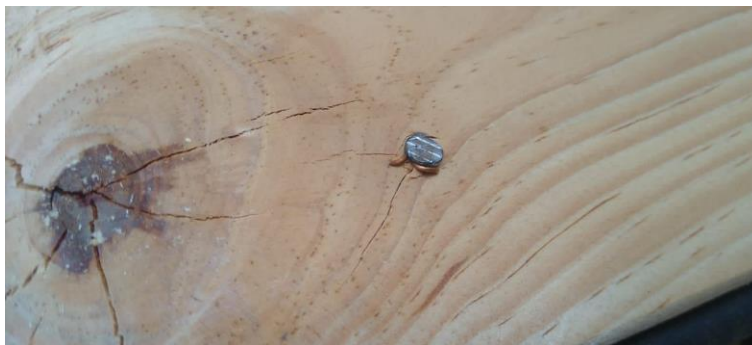
Figura 4.- Rotura de madera (elaboración propia, 2022)
