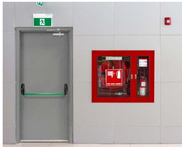
Imagen 2. Implementaciones inaccesibles por su altura.
