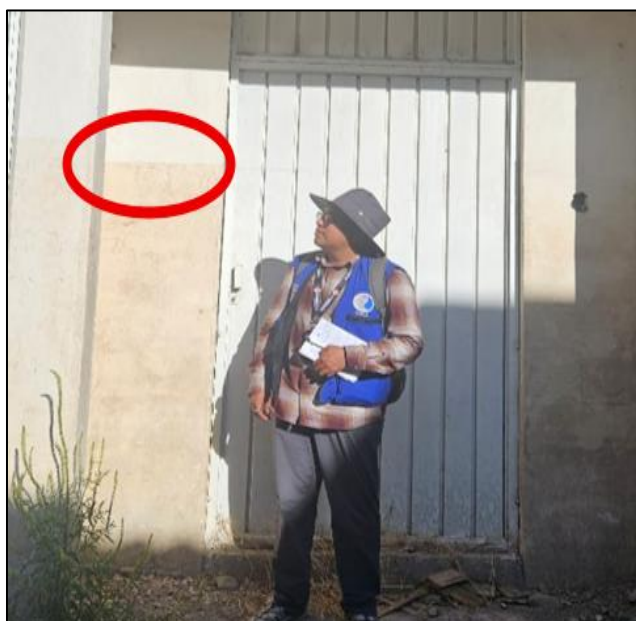
Figura 17. Marca de la humedad del nivel del agua máximo y estable de la inundación
