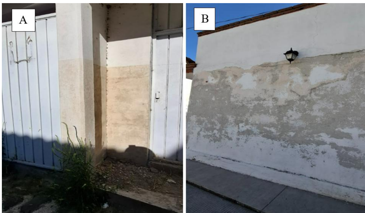
Figura 47. Marcas de humedad del nivel del agua a y b
