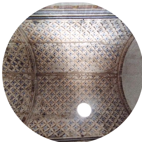
Imagen 81: Grietas y fisuras en la parte central de la bóveda
