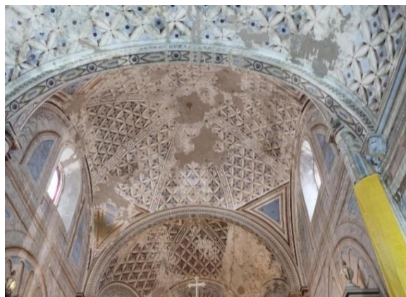
Imagen 1: Estado actual de las bóvedas del templo del Divino Salvador
