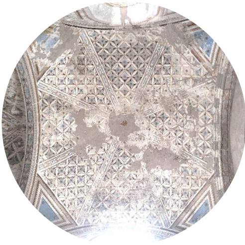
Imagen 80: Daños en la cúpula de gallones
