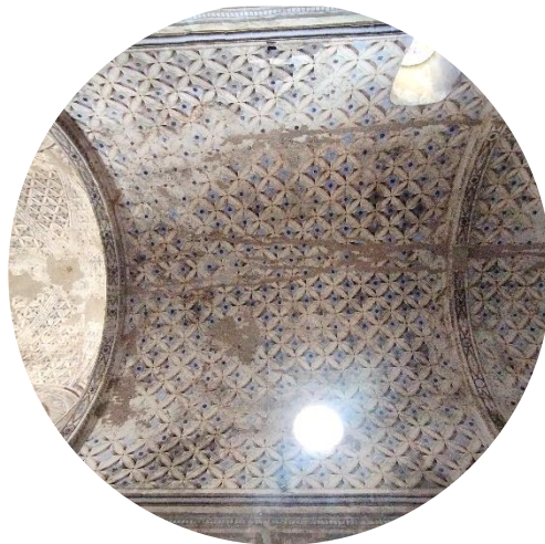
Imagen 79: Grietas y fisuras en la parte inicial de la bóveda
