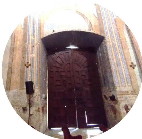
Imagen 82: Grietas y huecos por material faltante en puerta lateral
