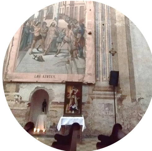
Imagen 83: Desprendimiento de aplanado cal-arena y pintura
