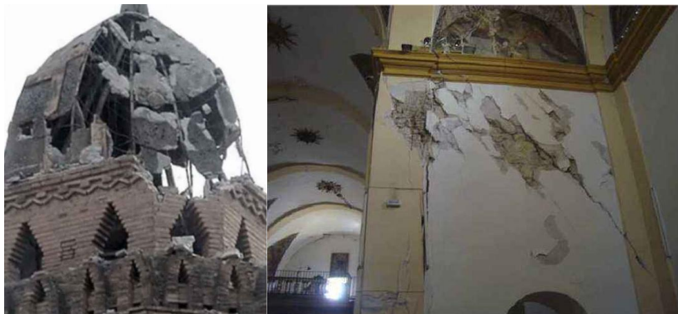
Imagen 65 y 66: Daños en la estructura del templo
