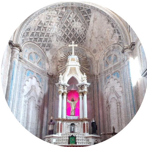
Imagen 78: Grietas y fisuras en ábside y altar mayor
