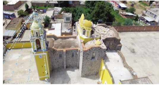
Imagen 47: Fotografía aérea del templo tras el sismo
