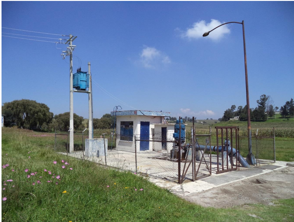
Figura A1 Pozo de extracción de agua del municipio de Ixtlahuaca
