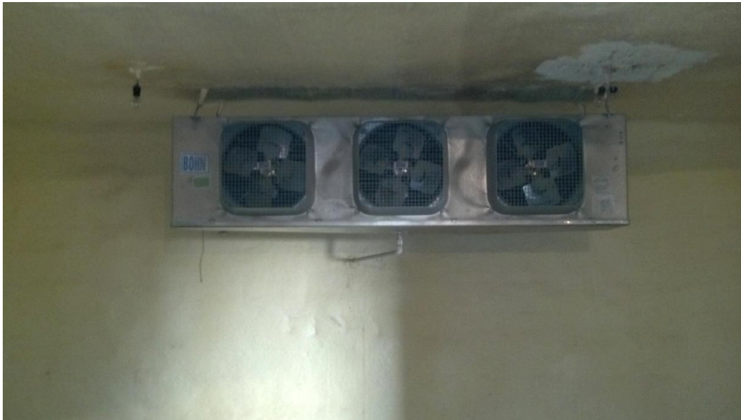
Figura 49. Cámara frigorífica con difusores de aire y HR.
