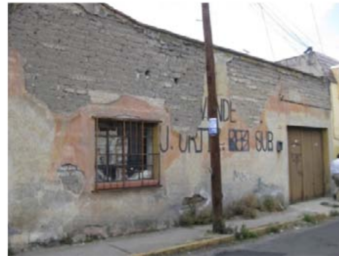
Imagen 3.5. Aspecto de una casa típica del Barrio de San Sebastián con un gran deterioro. Autor
