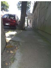
Foto 7. Estado de las baquetas, obstáculos y desniveles.
