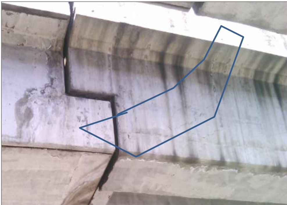
Figura 28. Trabe con escurrimientos y grietas.
