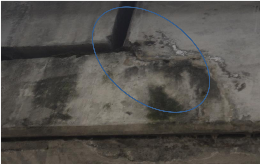
Figura 29. Cabezal con grietas e inicio de corrosión en el concreto.
