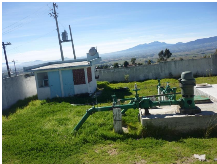
Figura. 2. Subestación y sistema de bombeo en el pozo profundo de Yebuciví
