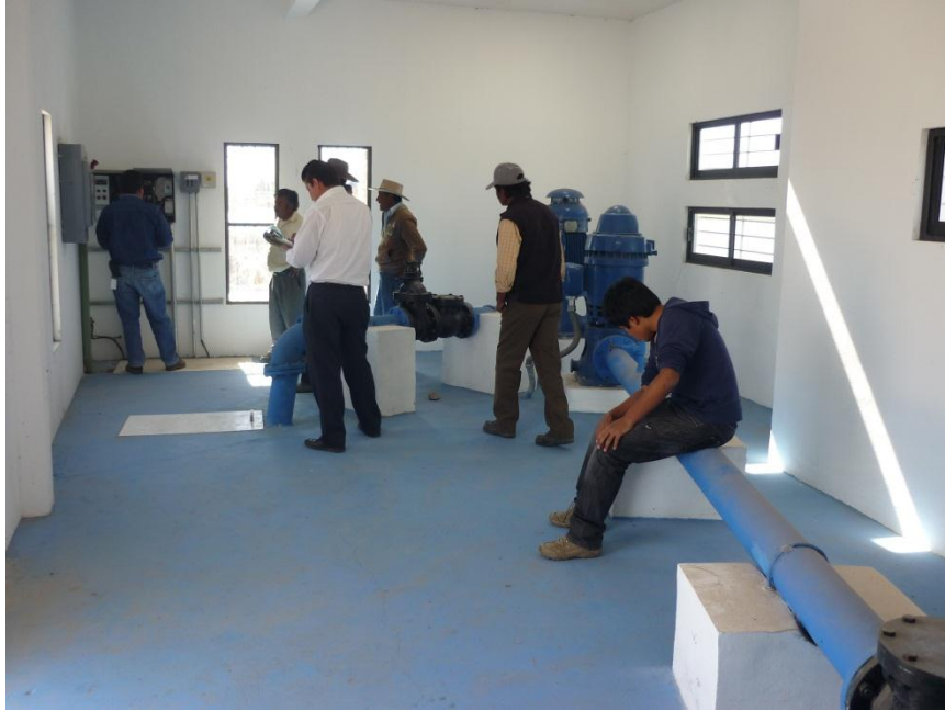
Figura. 6. Sistema de rebombeo en la Presa “El Nigüe”, Ejido el Sitio
