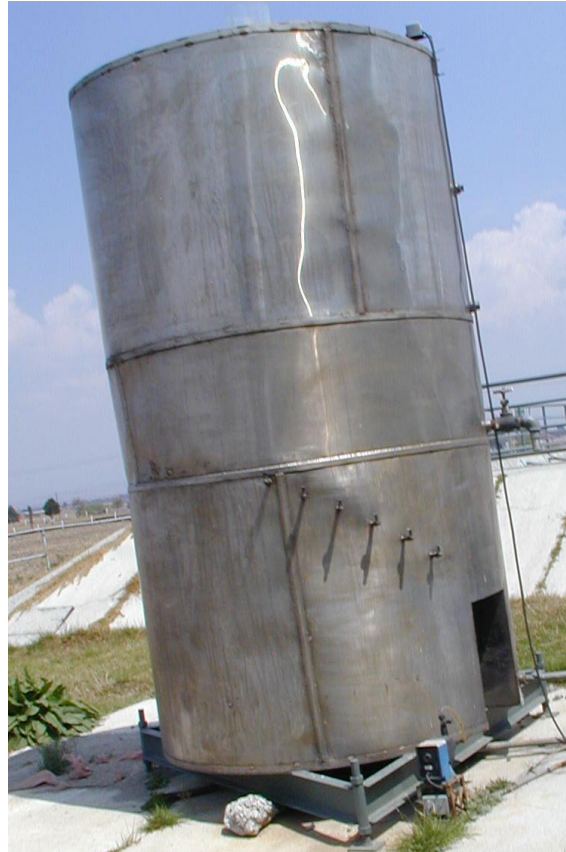
Figura M-5. Válvulas de muestreo para evaluación del manto de lodo.
