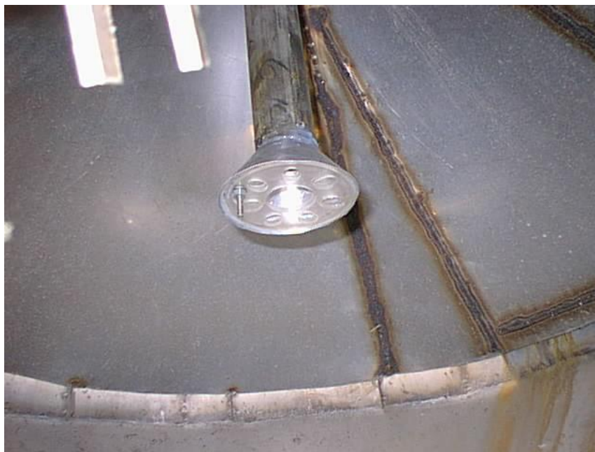
Figura M-3 B. Tolva superior de la planta piloto potabilizadora.
