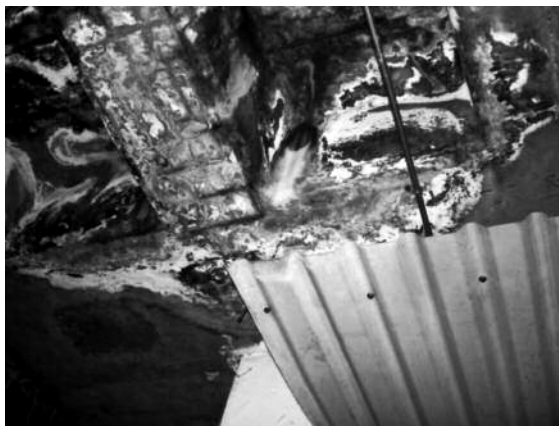
Foto 7. Aspecto de deterioro que presenta la losa de cubierta del estacionamiento ubicado dentro de la Plaza Ángel María Garibay
