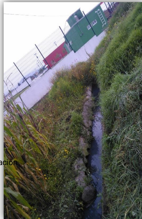
Fotografía 8. Canal obstruido por el hospital y la unidad deportiva (Fuente:Elaboración propia).
