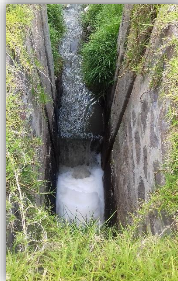
Fotografía 2. Compuerta abierta (Fuente: Elaboración propia).
