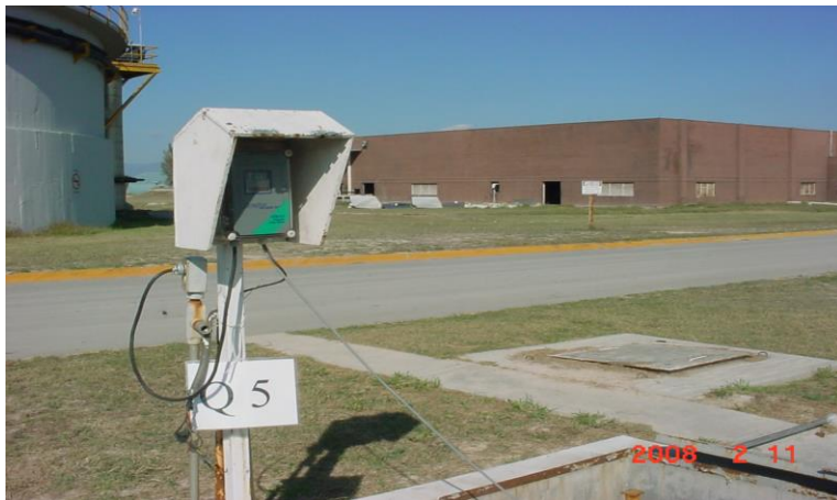
Flujómetro tipo doppler. Medición lodos primarios ( Q_5 ). Tubo de 8".
