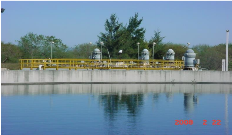
Estación de bombeo de lodos (EBL). Purga y recirculación
