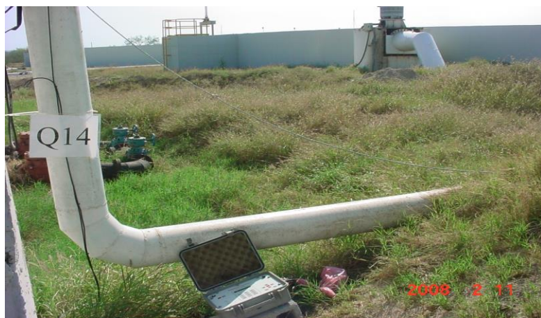
Flujómetro tipo doppler. Purga de lodos CS 2 (Q 14 -WAS1). Tubo 8".
