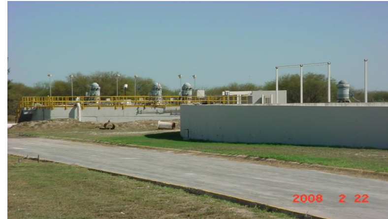
Otra toma de la EBL ubicada a un costado del CS 2
