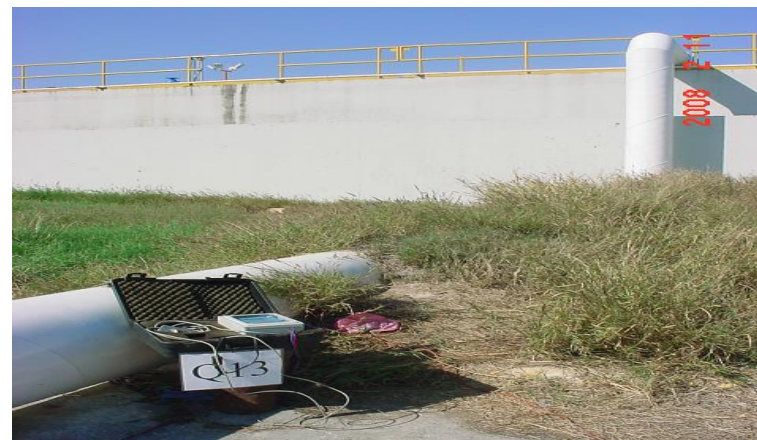
Medidor doppler en retorno de lodos del CS 2 (Q 13 ). Tubo 24"
