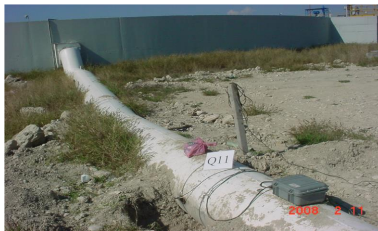
Medidor de efluente de CS 2 (agua de venta). Tubería 24" (Q 11 )
