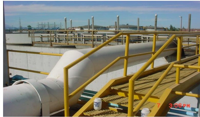
Estación de recirculación de lodos (ERL). Se observa tubería de llegada independiente de la recirculación del CS 2
