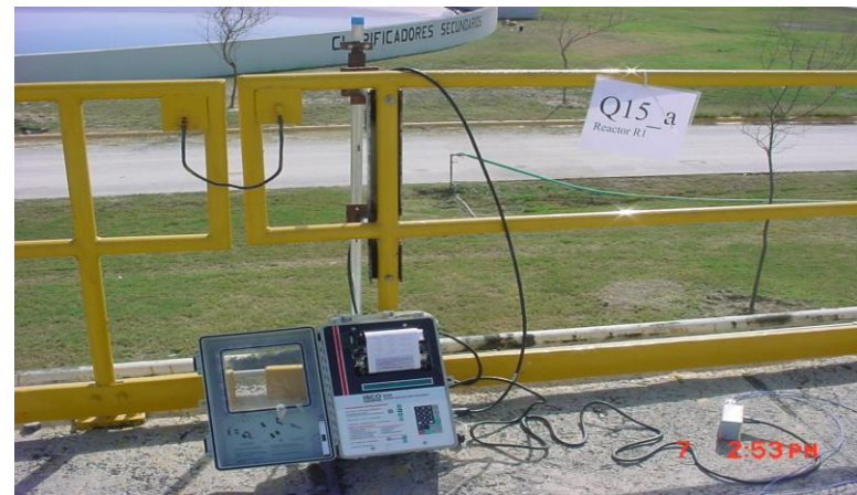
Medidor área-velocidad en efluente de R_1 ( Q_{15a} ). Flujo en canal.
