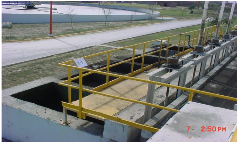
Caja repartidora de efluente de reactores (CR 3 ) a CS 1-6
