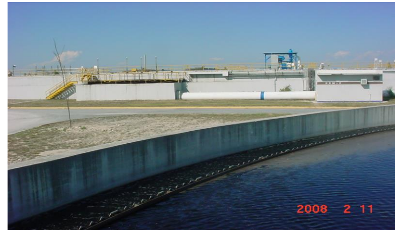
Otra toma de CR 3 , se observa la tubería independiente del R 5
