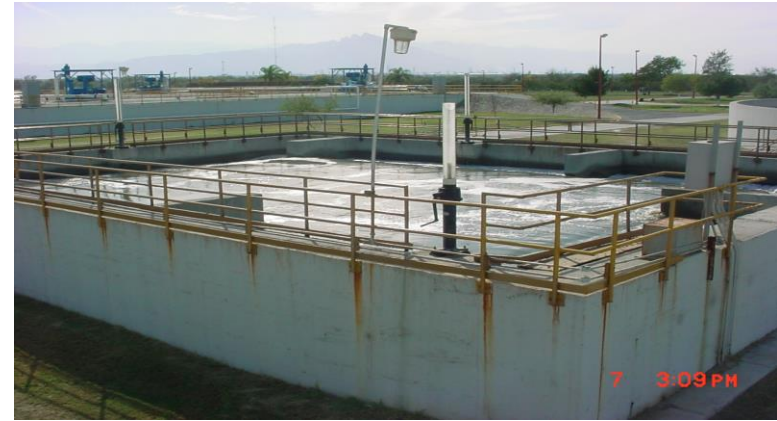
Otra vista de CR 2 , al fondo el sistema de reactores biológicos
