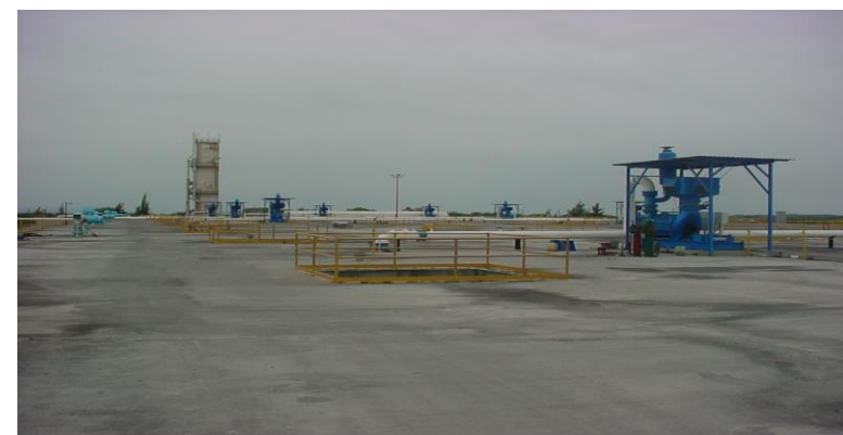
Vista de la plataforma de concreto que cubre al tren de reactores
