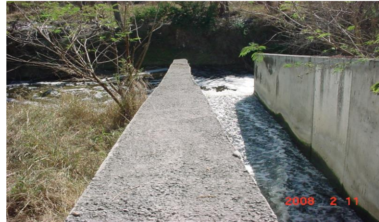
Canal de descarga de efluente hacia agricultura
