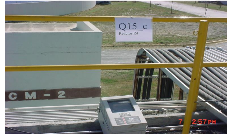
Medidor área-velocidad en efluente de R_4 ( Q_{15c} ). Flujo en canal.
