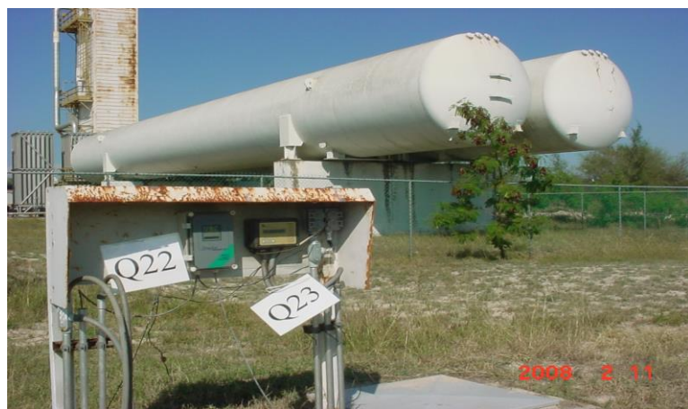
Medición de retorno y purga de lodos de R 1-4 (Q 22 y Q 23 )
