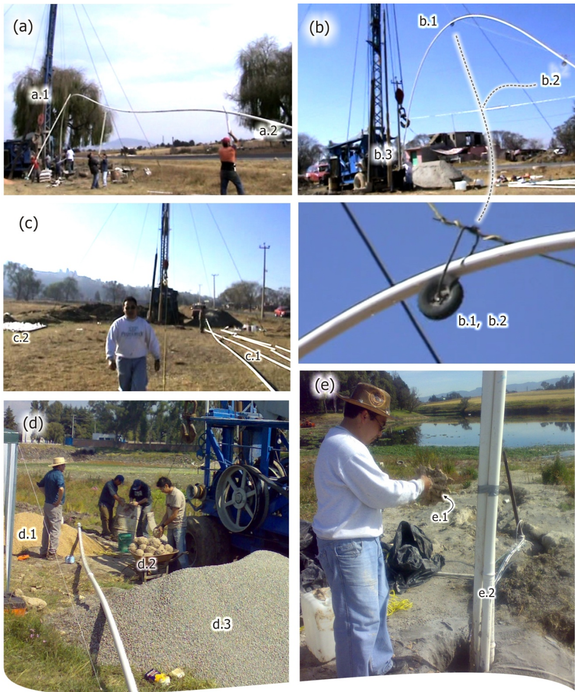
Figura 4.12 Fotografías de la instrumentación instalada en los pozos de monitoreo (a) Nevado; (b) y (c) Zolotepec; (d) y (e) Taborda. En (a) y (b) se comparan dos métodos para introducir los piezómetros en los pozos. En (c) se presenta una panorámica de (c.1) los tubos de los piezómetros y (c.2) las muestras de suelo. En (d) se aprecian los materiales de relleno. El aspecto previo a la instalación del contraademe se muestra en (e). Fuente: elaboración propia.
