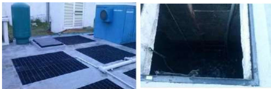
Figura 2. Planta de tratamiento de aguas residuales del hospital Adolfo López Mateos
