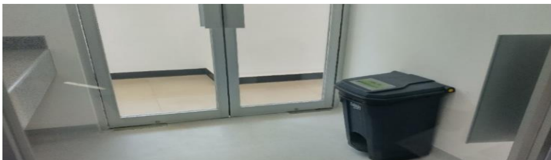
Figura No. 38: Barreras arquitectónicas.
