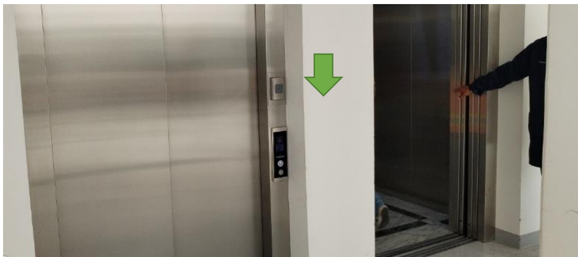
Figura No. 40: Falta de señalización en Ascensores.
