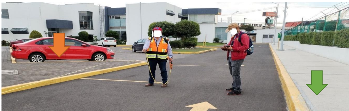
Figura No. 43: Banquetas no accesibles y sin rampas de acceso.
