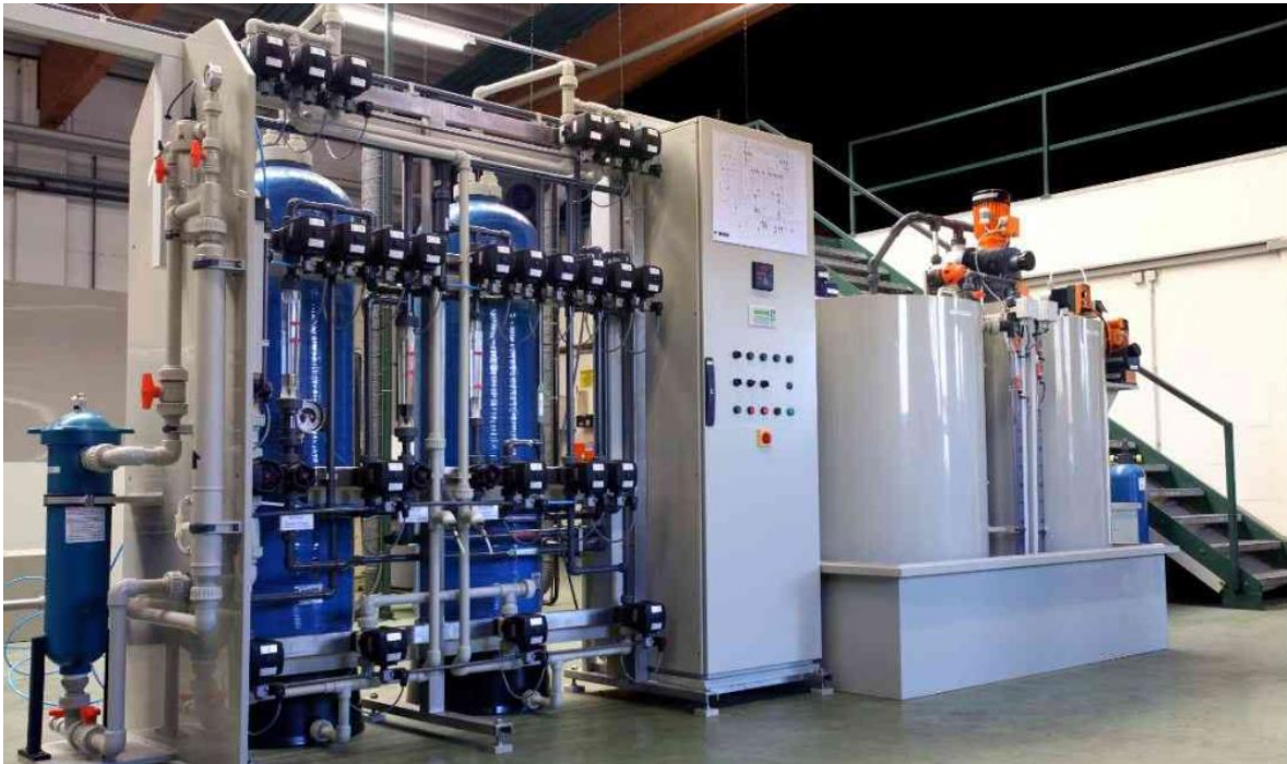
Figura 8 Ejemplo de un equipo industrial para el tratamiento de la dureza del agua por intercambio iónico. (Equipos Ósmosis Inversa, 2022)
