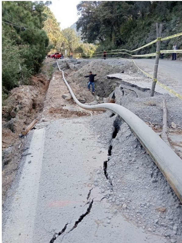
Figura 5. Vista general del colapso en el Km 51, carretera que comunica los municipios de Texcaltitlán y Sultepec
