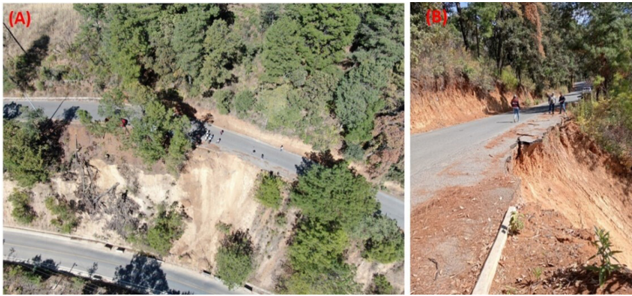
Figura 9. Deslizamiento carretero que conduce a la localidad de Agua Amarga. A: fotografía aérea y B: detalles del deslizamiento en suelo arcilloso
