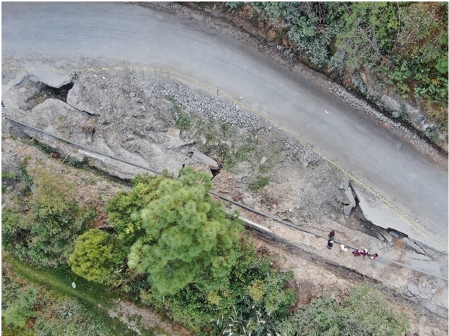
Figura 7. Impacto del colapso ocurrido en el camino 36
