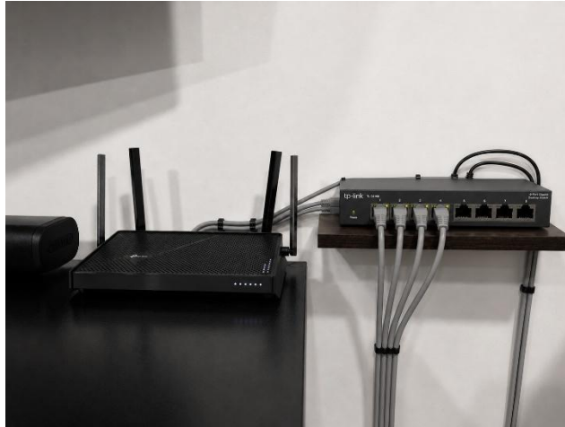
Figura 25 Instalación Router y switch sede 3.
