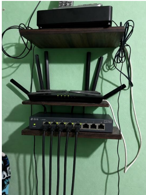
Figura 24 Instalación Router y switch sede 2.
