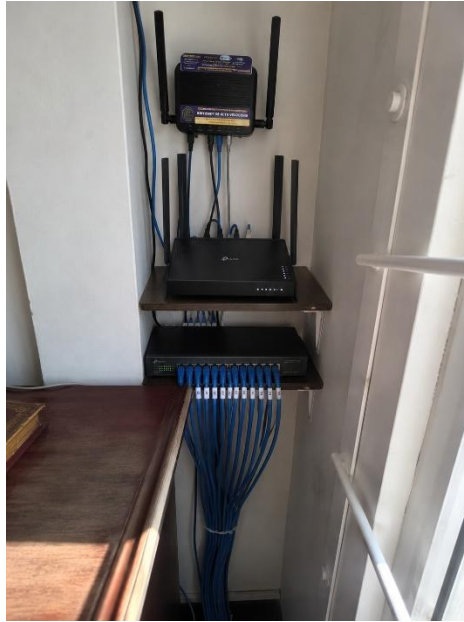
Figura 23 Instalación Router y switch sede 1.
