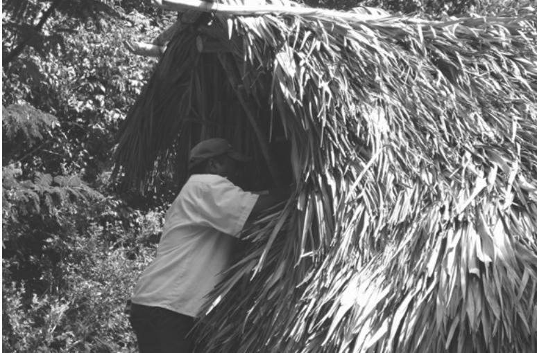
Figura 19 Socio de U Najil Ek Balam que repara el techo de palma de una cabaña
