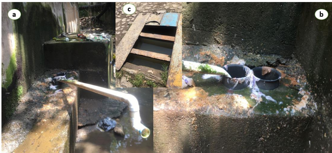
Figura 15: Condiciones actuales de la red de drenaje municipal de Valle de Bravo a lo largo del cauce del río Tizates.
