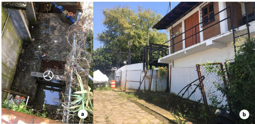
Figura 14: Infraestructura de recolección y bombeo de aguas residuales: a) Colector residual de Tres Puentes y b) Cárcamo de Bombeo No. 1 de CONAGUA.
