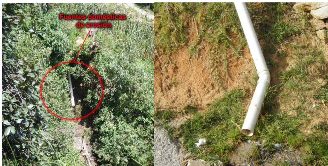
Foto 27 y 28: Fuentes domésticas de erosión.
