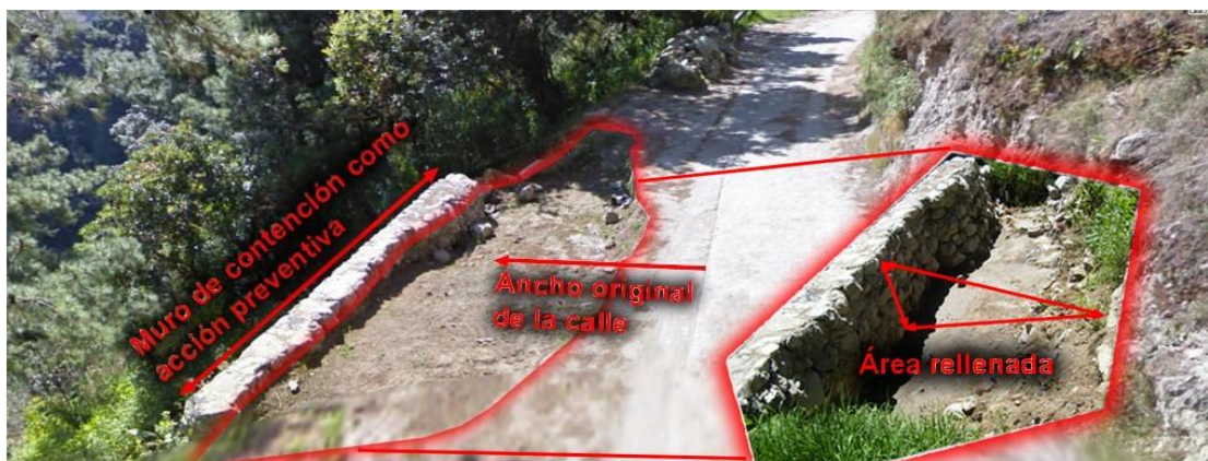
Foto 22: Caída de material (Pc 64).
