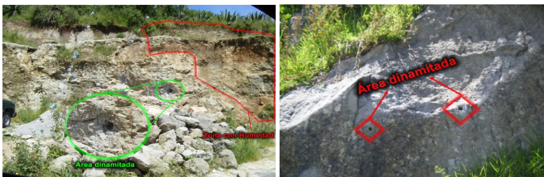
Foto 25: Zona de humedad y Área dinamitada (Pc 71).
