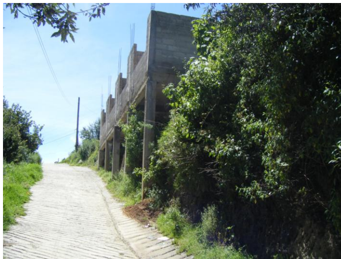
Foto 21: Caída de material (Pc 63).
