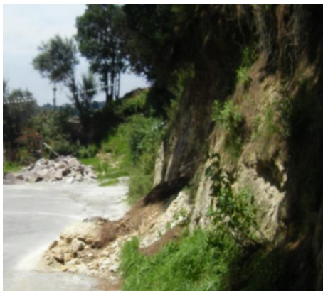
Foto 53: Caída de material.
