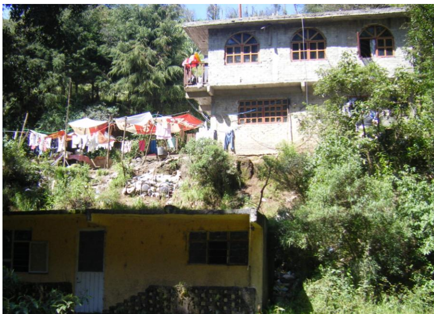
Foto 26: Vivienda bajo amenaza de Movimiento del Terreno. Lugar: Zona Juashy, Santa Cruz Ayotuxco.
