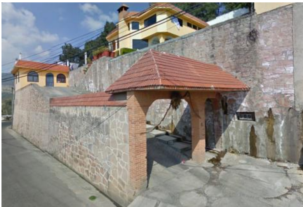
Foto 38: Humedad en las paredes de la construcción. Lugar: Zona Agua de Tejamanil, Santa Cruz Ayotuxco.
