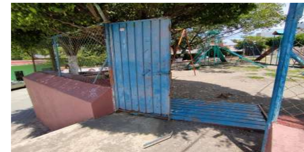
Ilustración 1. Estado de conservación del Parque Infantil “La alameda” Col. San Andrés, Teloloapan, Guerrero. FUEENTE: Propia 2022.
