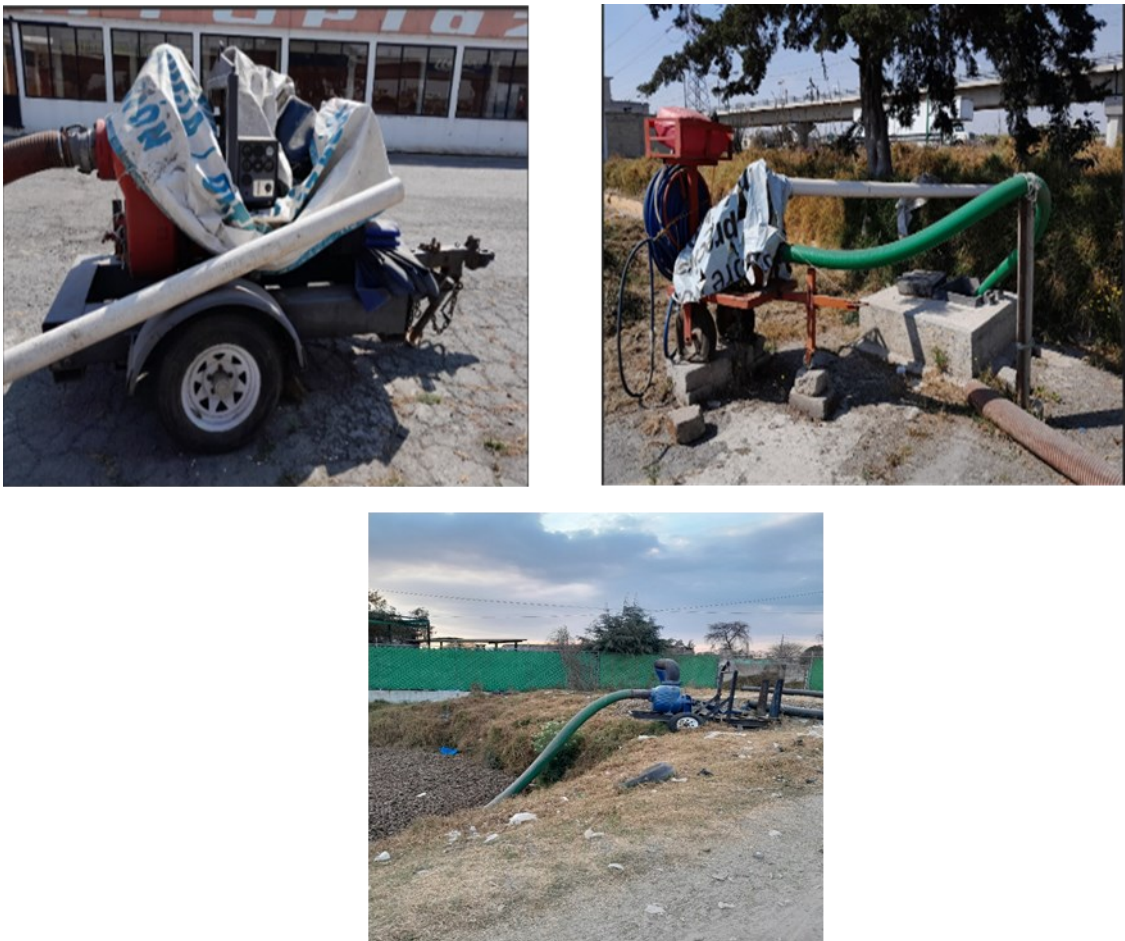
Figura 63. Sistema de bombeo (Bomba Thompson y una hidraflow) Sistema de bombeo y drenado en el municipio de San Mateo Atenco I
