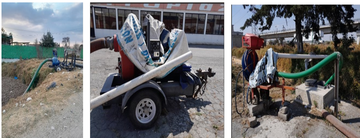
Bombas usadas por el municipio para mitigar los impactos de las inundaciones en el municipio de San Mateo Atenco.
