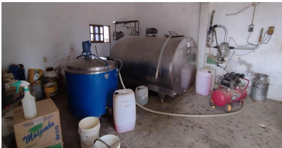
Figura 40. Bomba de succión y contenedores de almacenamiento con sistema de refrigeración, actualmente fuera de funcionamiento
