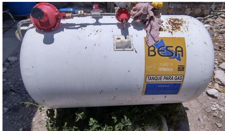
Figura 48. Tanque de almacenamiento de gas LP usado para calentar la caldera
