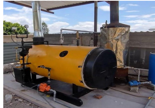
Figura 53. Calderas de la UP: La de color amarillo es la reconstruida usada en la producción actual. Mientras, la plateada es un modelo viejo (igual que la caldera destruida) solo usada en caso de no disponer de la principal
