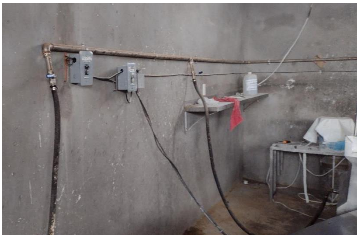
Figura 47 Tuberías de sistema de vapor, que dirigen el vapor hasta las cubas de preparación
