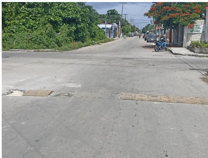
Figura 21. Tope dañado y con baches en colonia popular
