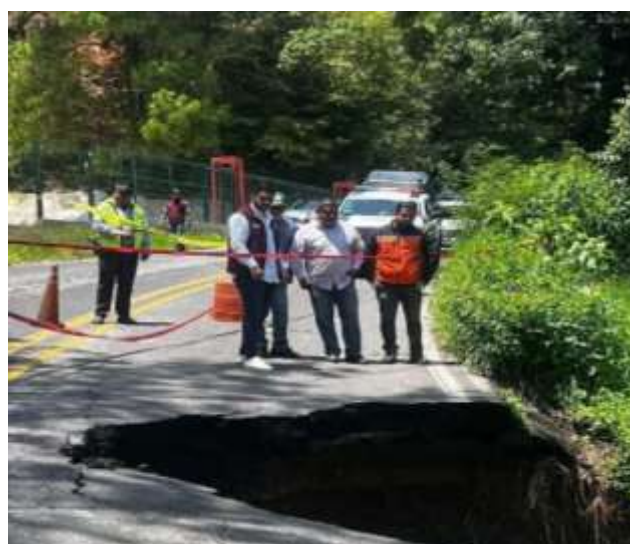
Figura 11. Hundimiento en la carretera Texcaltitlán-Sultepec, cerca de Tejupilco. Creación de un socavón que obligó el cierre del tramo carretero por riesgo de colapso total (Capital Edomex , 2024).
