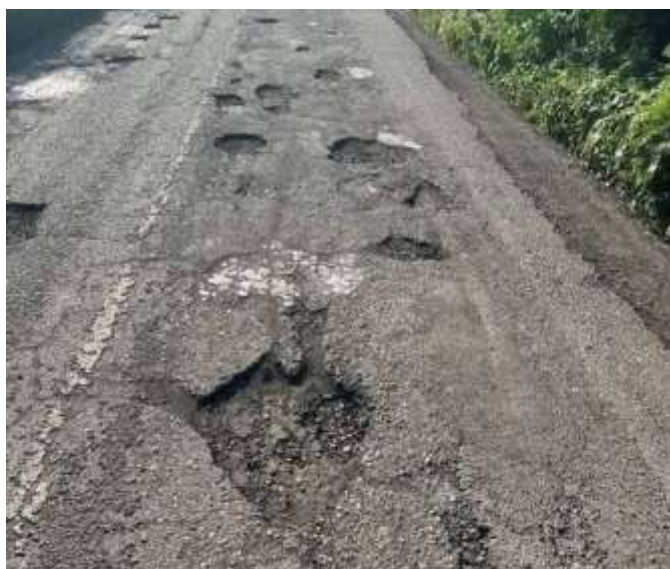
Figura 10. Carretera Federal 134 Toluca – Altamirano con numerosos baches, especialmente en curvas peligrosas. (Capital Edomex , 2024), (Rodríguez, 2024).
