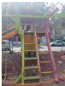
Figura 164. Desgaste de material y falta de mantenimiento
