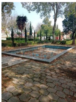
Figura 133. Fuente de agua sin protecciones laterales
