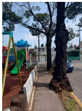
Figura 126. Obstrucción del paso peatonal por raíces de arboles
