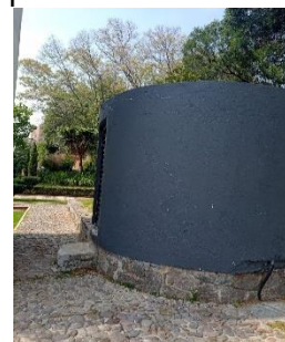
Figura 131. Escalón que obstruye el paso
