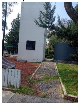
Figura 124. Obstrucción con pasto en uniones del adoquín
