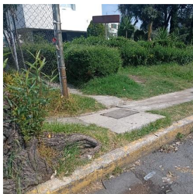
Figura 159. Obstrucción de banqueta por raíz de árbol
