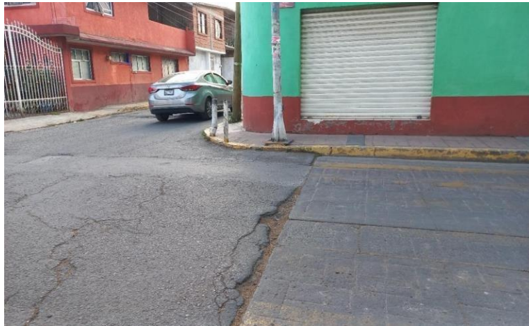
Ilustración 54 Grietas en el pavimento
