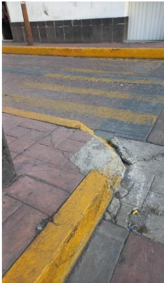
Ilustración 43 Fractura de banqueteta en esquina
