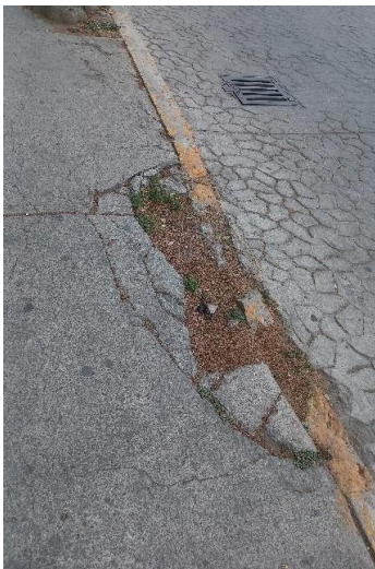
Ilustración 41 Fractura y hundimiento de banqueta
