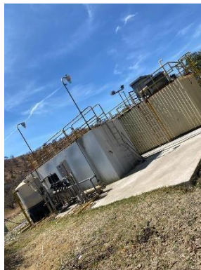
Figura 20. Planta de tratamiento de aguas residuales
