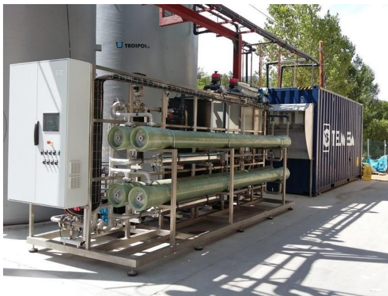
Figura 8. Planta de Osmosis Inversa.
