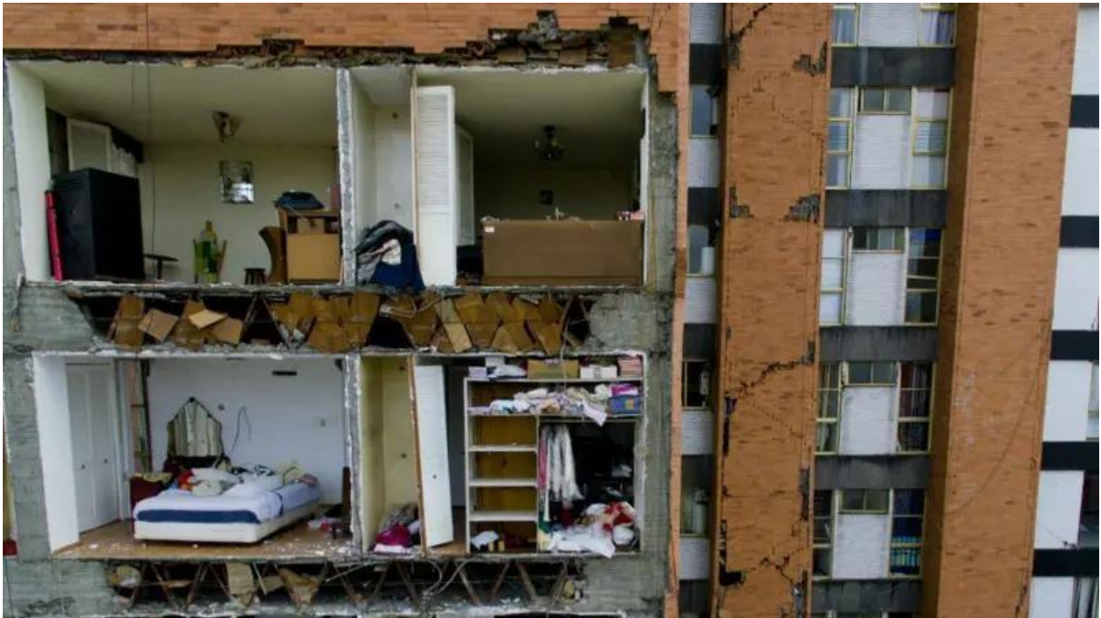
Imagen 27. "Edificación mal construida dañada por el sismo, Ciudad de México, 2017".
