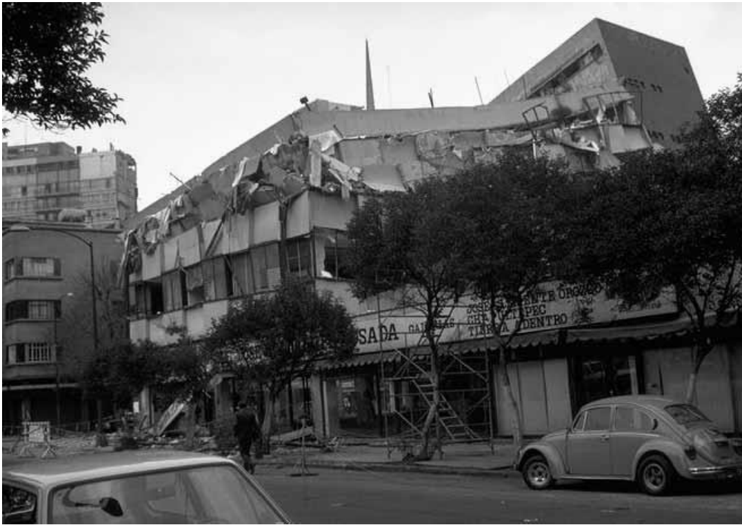
Imagen 21. Daños en edificio de departamentos en la Zona Rosa, Ciudad de México, 1985.
