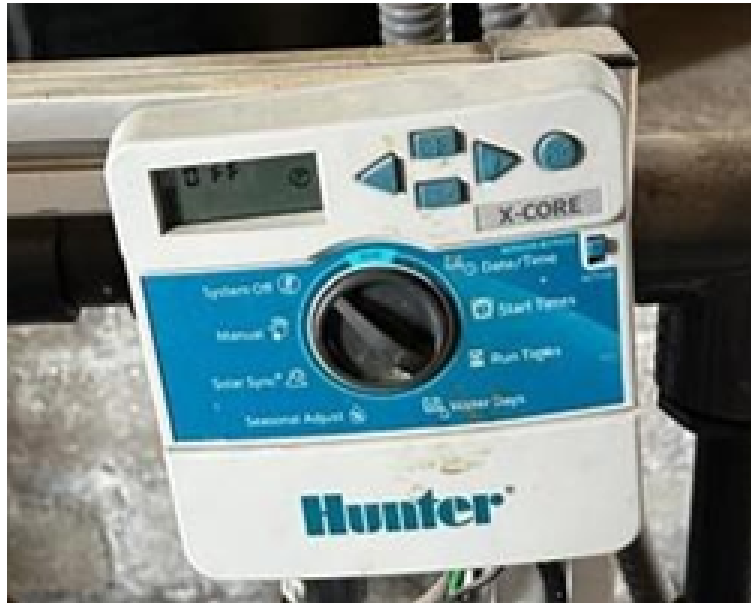
Figura 3.8: Fotografía del programador de riego
