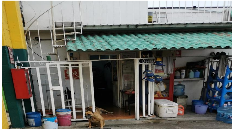
Imagen 5. Área de Vigilancia con equipo contra incendios y acceso a la bomba de hidrante.
