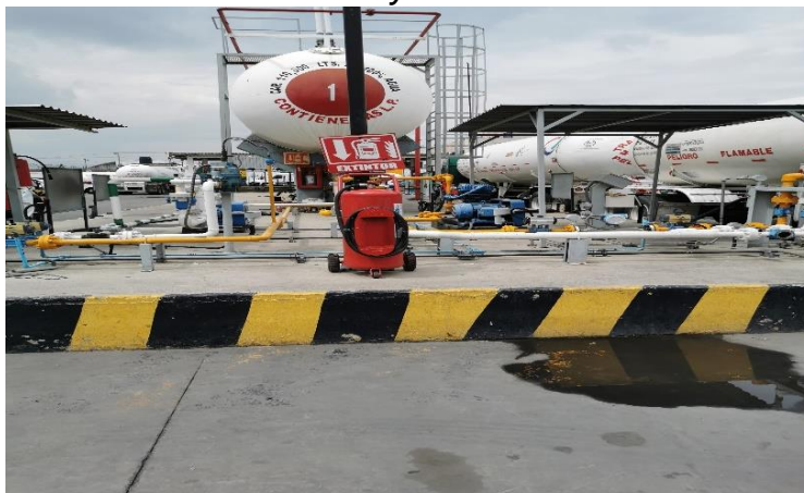
Imagen 6. Área de almacén y trasiego de Gas L.P. con extintor y señalizaciones.
