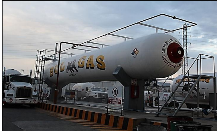
Imagen 3. Almacenamiento de Gas Licuado de Petróleo con capacidad de 110,000 litros.
