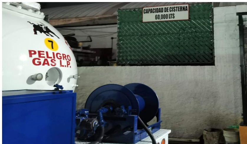
Imagen 9. Área de máquinas y bombas (sistema contra incendios)
