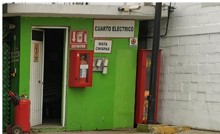
Imagen 17. Área de estación eléctrica con sus respectivas señalizaciones y equipos contra incendios.
