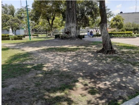
Fotografía 153. Erosión en el área verde del jardín.
