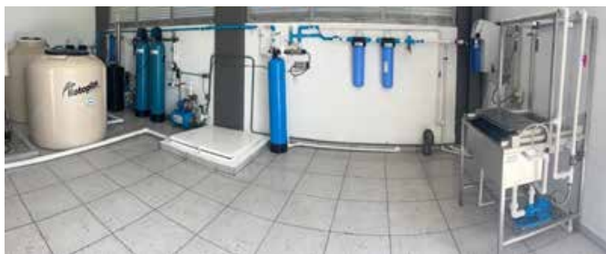
Figura 5. Sistema de Captación de agua de Lluvia ICAR- UAEMEX. Elaboración propia.
