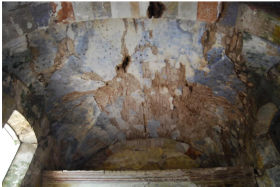
Foto 1. Daños en la cubierta de la capilla, ocasionados por agrietamientos de la bóveda y agravados por las filtraciones de agua. Fuente propia.
