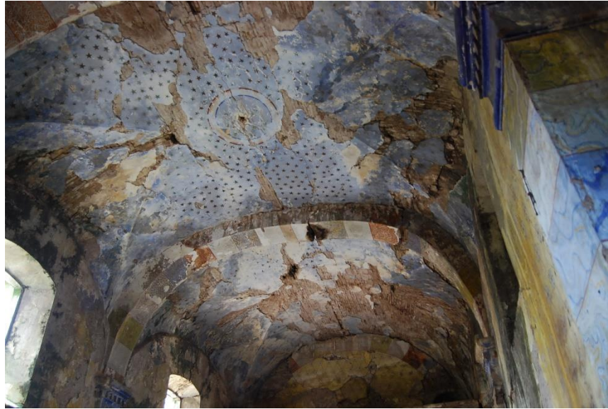
Foto 2. Daños en la cubierta de la capilla, ocasionados por agrietamientos de la bóveda y agravados por las filtraciones de agua. Se aprecia la deformación del arco de manera alarmante. Fuente propia.
