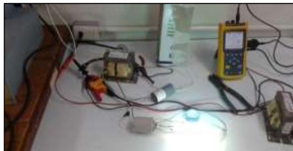
Figura 7. Medición en sitio de una lámpara de aditivo metálico (encendida parcialmente al instante de la fotografía)
