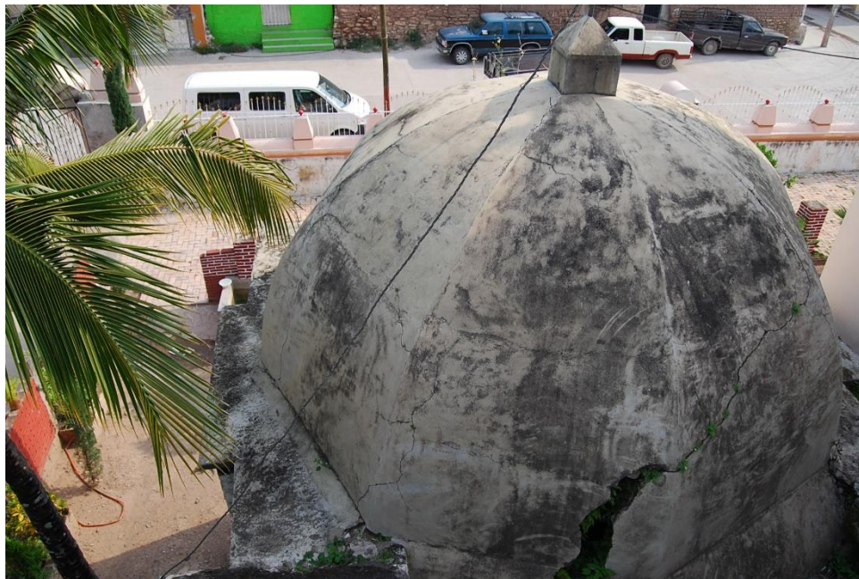
Foto 2. Daños en la cubierta del baptisterio, ocasionados por agrietamientos de cúpula y agravados por las filtraciones de agua. Fuente propia.
