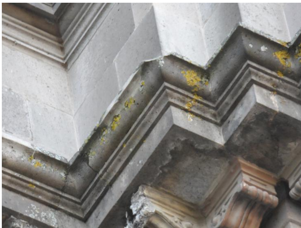
Figura 271 Alteración debida a la acumulación de líquenes
