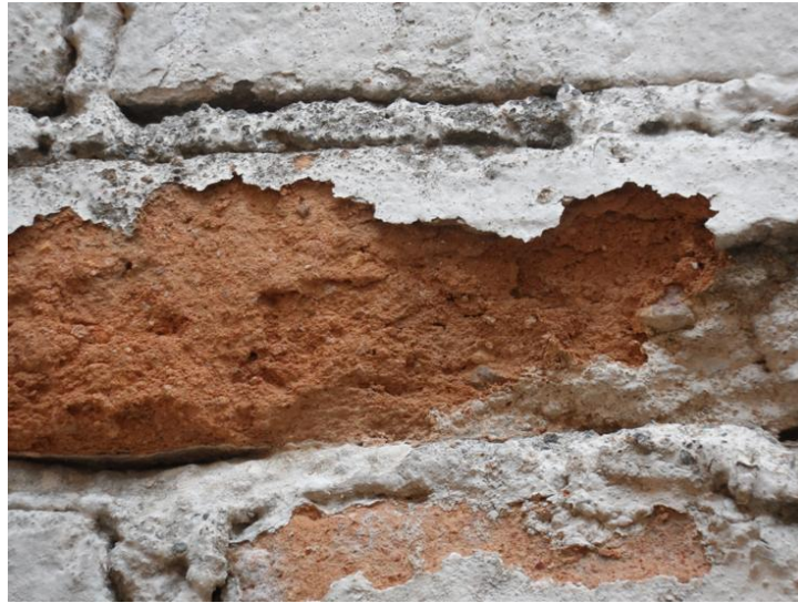
Figura 9 En esta Figura se observa la corrosión debida a la incompatibilidad de materiales, entre el ladrillo y el mortero cementante entre los ladrillos. Haber aplicado pintura vinílica solamente oculto temporalmente el proceso de disgregación.
