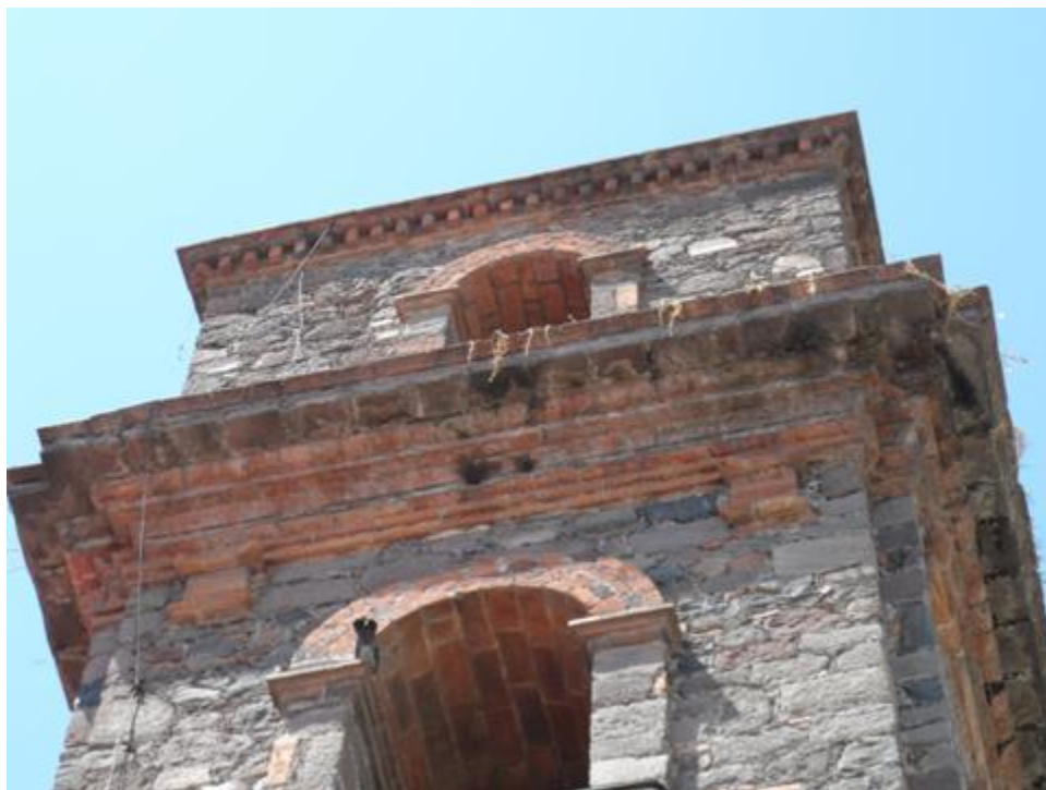
Figura 293 Aspectos del Campanario, las manchas negras son colonias de líquenes
