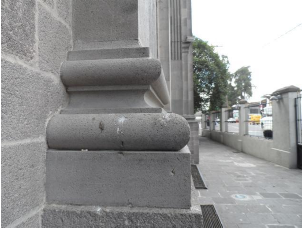
Figura 274 deterioro de la base de las columnas
