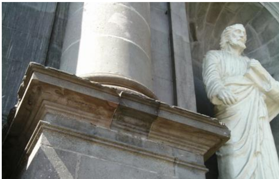
Figura 247 Deterioro del material pétreo
