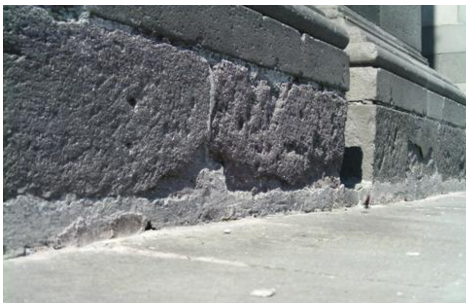
Figura 250 Deterioro irreversible del material pétreo
