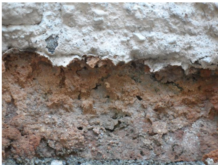
Figura 6 Esta es la parte más antigua de la barda. La calidad de los ladrillos es diferente, obsérvese la gran porosidad del ladrillo rojo que en cierta forma le sirvió para poder “transpirar” y no acumular agua que pudiese causar la arenización, sin embargo haber pintado el revoco propició el aceleramiento del desgaste.
