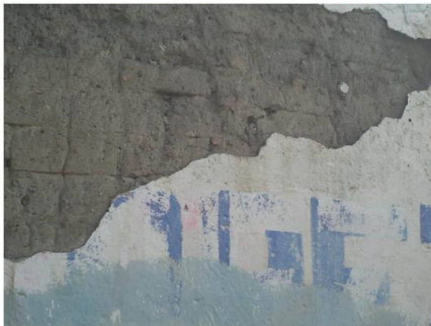
Figura 146 Muro de adobe con aplanado a base de cal. Centro Histórico Toluca Méx.
