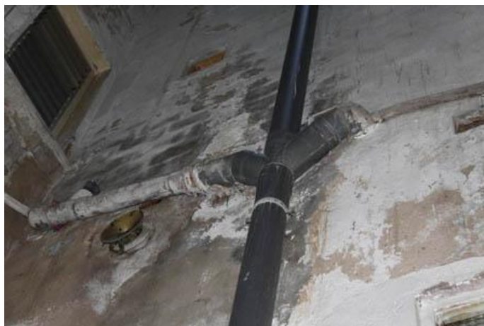
Figura 182 Fugas en drenajes http://itegroup.es/es/
