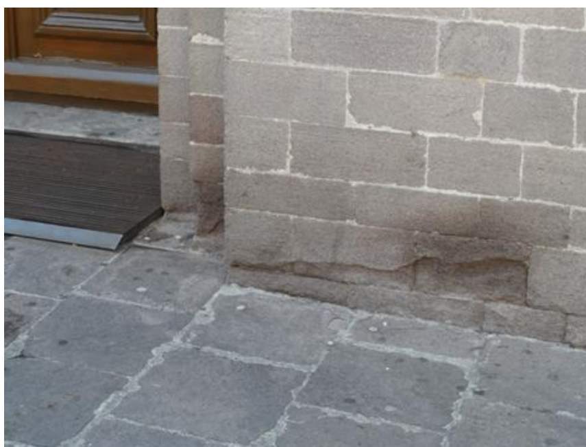
Figura 277 Desgaste del material pétreo debido a la existencia de humedad
