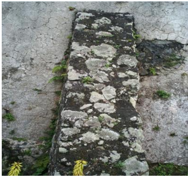
Figura 56 Contrafuerte Muro lateral de la Casa Grande de la Hacienda de El Jobo en Veracruz. Obsérvese la existencia de líquenes blancos y negros
