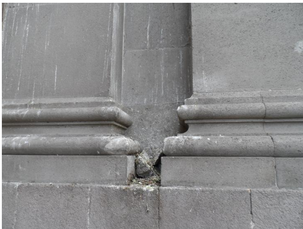
Figura 267 Detalles de la falta de mantenimiento de la Fachada
