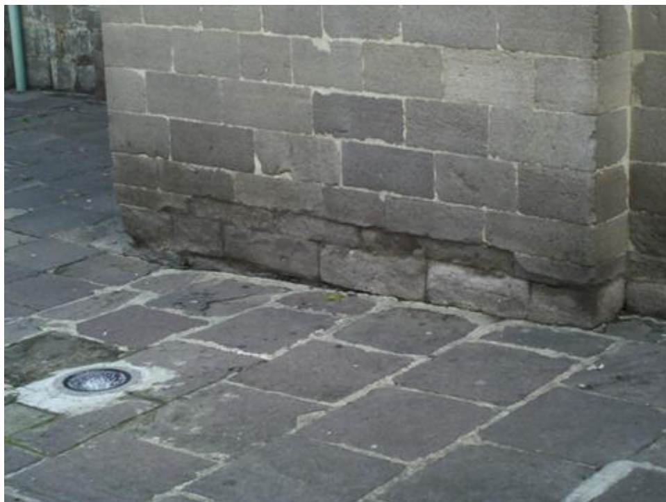
Figura 278 Deplacamiento por humedad
