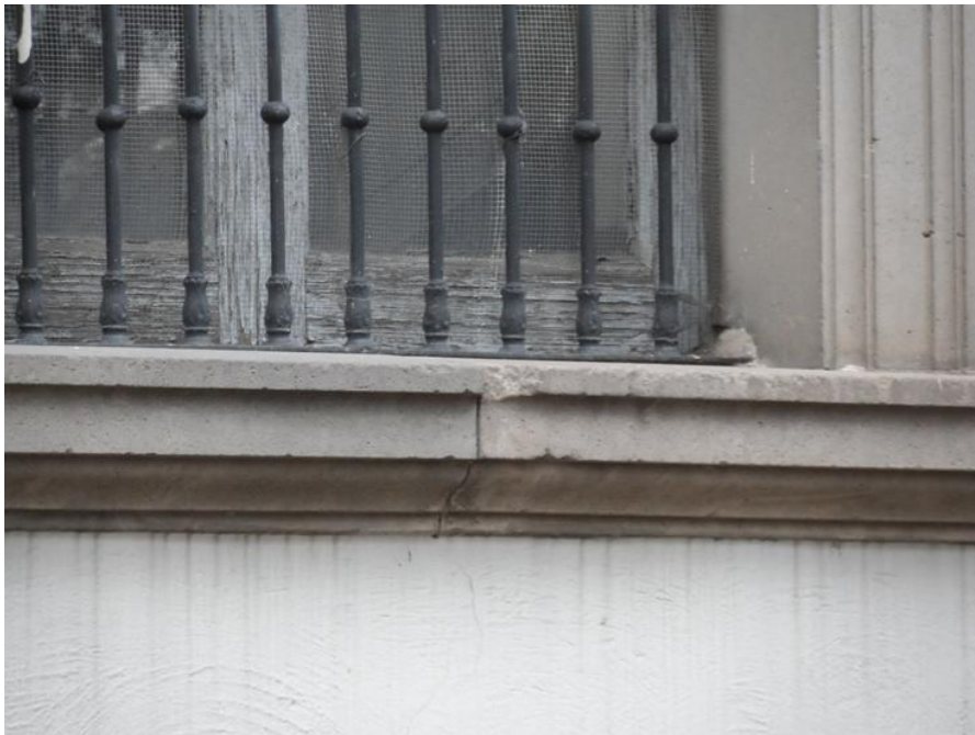
Figura 283 Agrietamiento del material pétreo patologías constructivas
