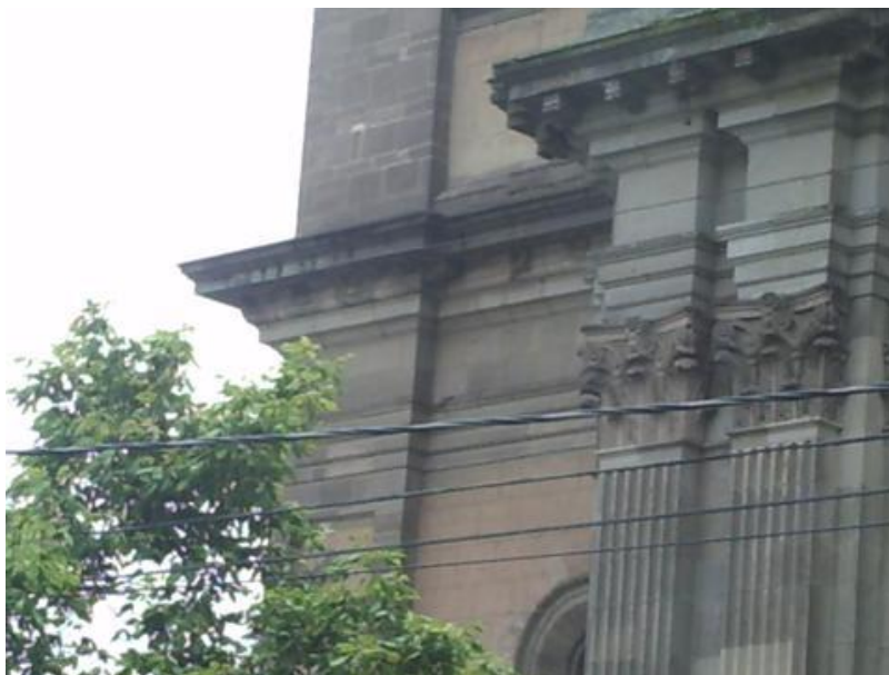
Figura 262 Esgurrimientos de agua pluvial
