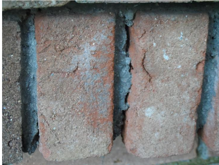
Figura 7 Estos ladrillos están en una parte de la barda que esta sujeto a estrés hídrico, es decir, ciclos alternados de humedad a saturación y deshidratación, lo que ha causado las grietas intergranulares. Además se puede observar claramente la corrosión en materiales pétreos, obsérvese que el mortero cementante esta despegado del ladrillo.
