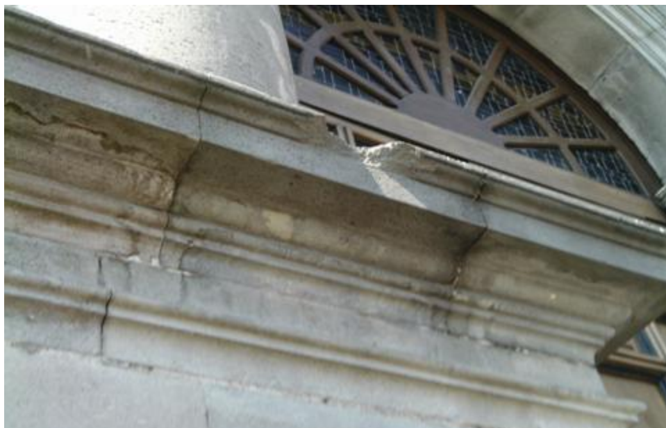
Figura 249 Fractura del material pétreo Pórtico Principal
