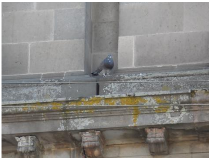
Figura 268 Destrucción de cornisas y frisos en la fachada principal
