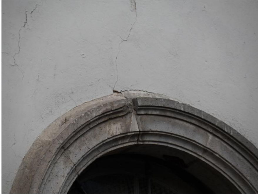
Figura 282 Agrietamiento de origen constructivo
