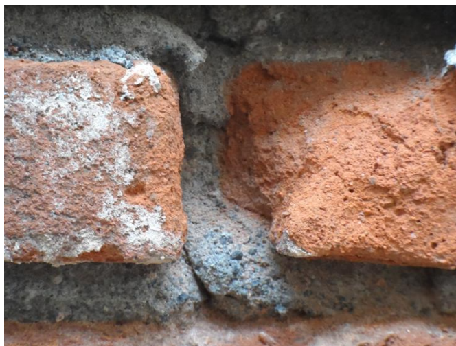
Figura 2 Aquí se puede observar que ha habido un desgaste mayor en el mortero cementante que en el tabique debido a su pobre calidad, véase las eflorescencias blancas sobre este mismo material.
