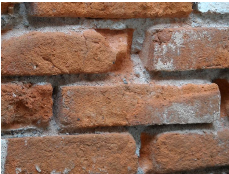
Figura 5 Aquí existe un efecto múltiple, se puede observar, desgaste arenización y eflorescencias blancas. Aquí la barda esta en un jardín y tiene humedad constante a ambos lados de la barda.
