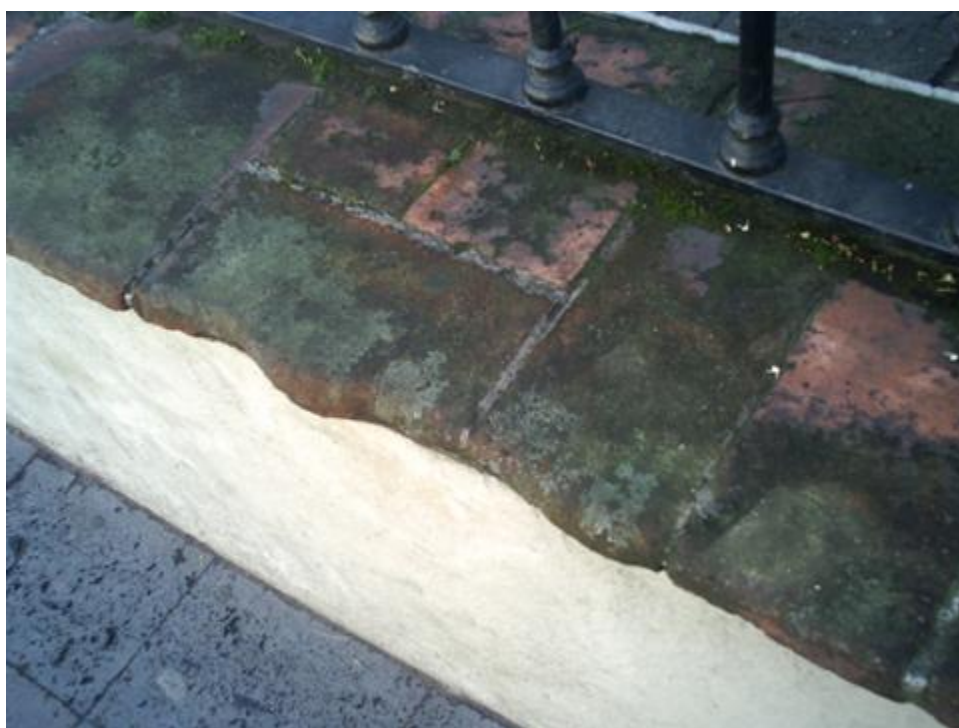
Figura 279 Desgaste del material pétreo debido a la existencia de humedad
