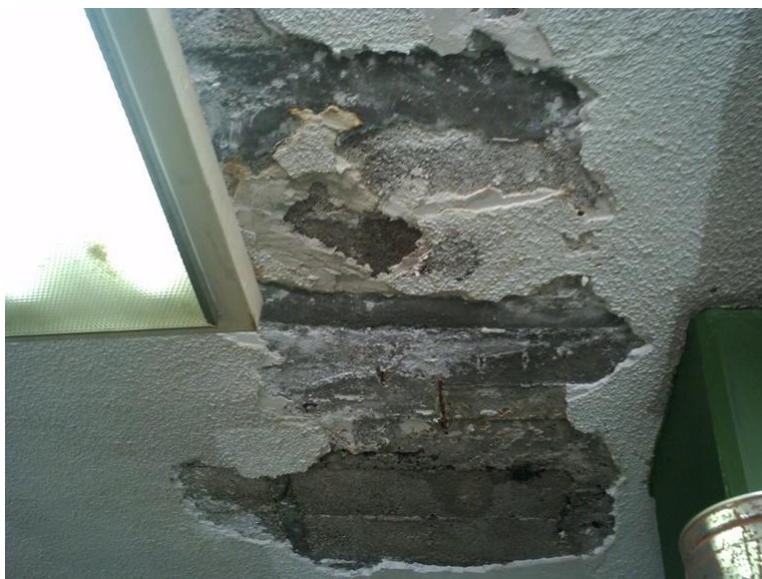
Figura 181 Goteras por mala impermeabilizado Edificio Universitario
