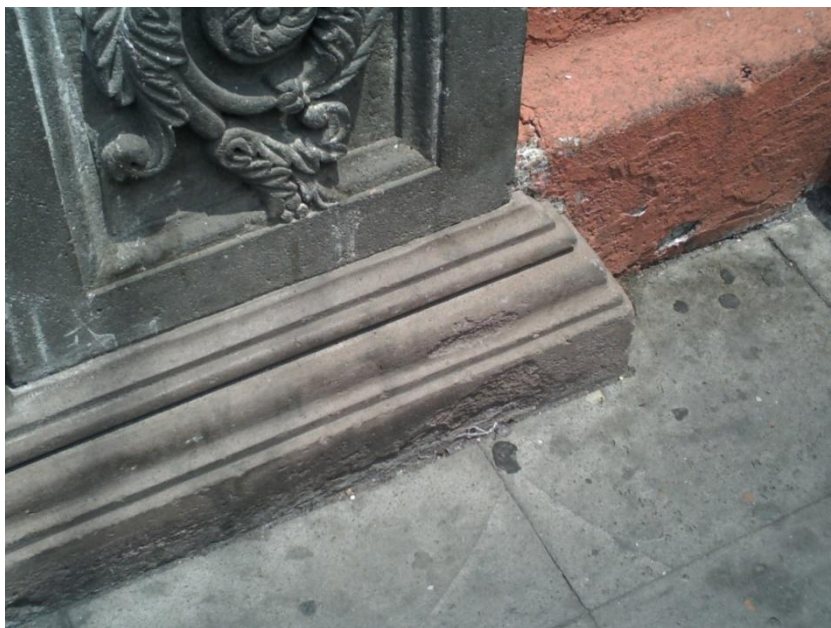
Figura 179 Deplacamiento Edificio BBVA Bancomer Los Portales Toluca Méx.
