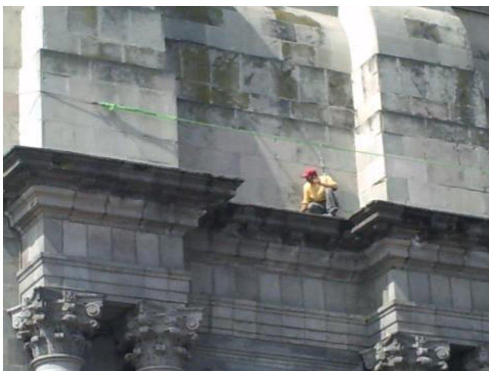
Figura 252 Intervenciones con alto grado de inseguridad
