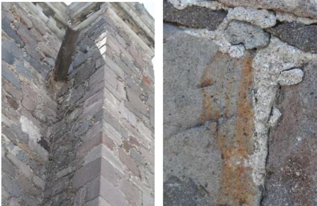
Figura 295 Aspectos de las paredes laterales, las manchas negras son líquenes, el escurrimiento rojizo es óxido de hierro
