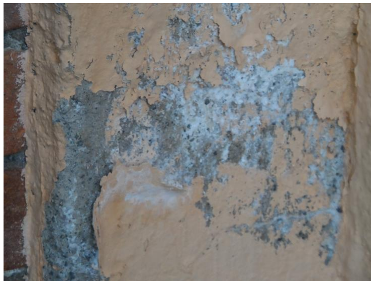
Figura 10 Esta Figura muestra un castillo de concreto en donde se presentan las eflorescencias blancas, mismas que comenzaron a botar la pintura.
