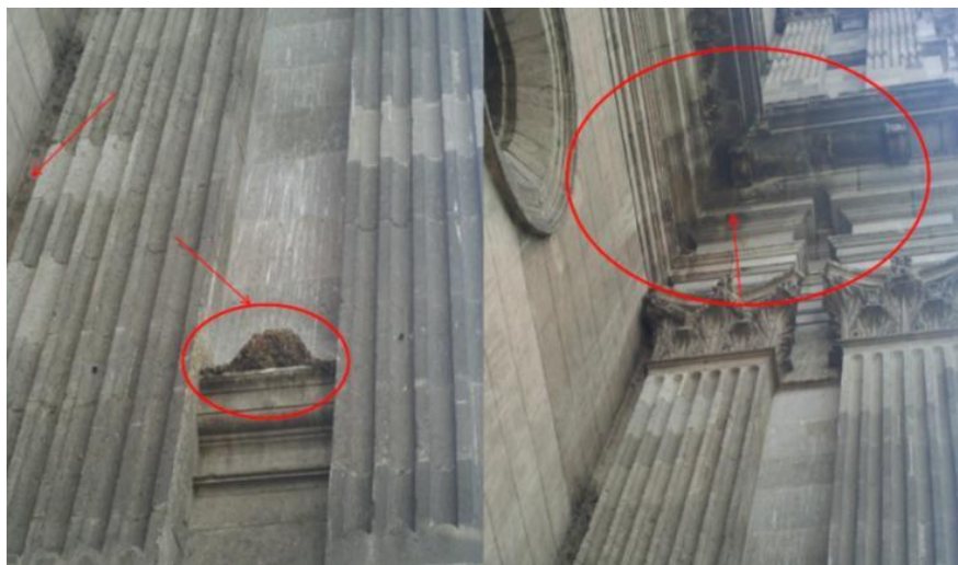
Figura 303 deterioro por falta de mantenimiento
