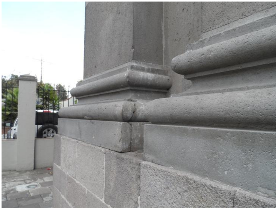
Figura 275 Agrietamiento del material pétreo
