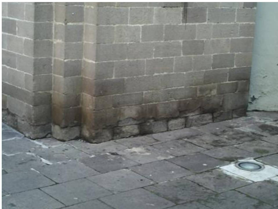
Figura 276 Deterioro del material pétreo por humedad capilar ascendente
