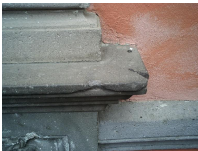
Figura 178 Pérdida de material Edificio BBVA Bancomer Los Portales Toluca Méx.
