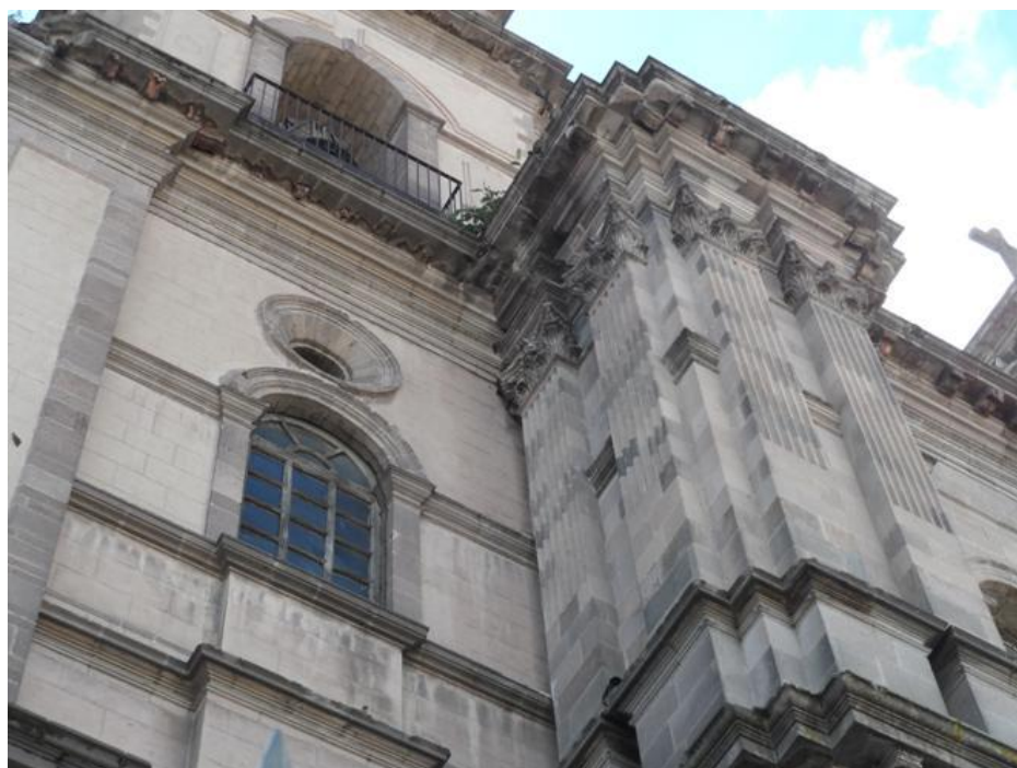
Figura 273 Detalle de la fachada y biocolonización en manchas oscuras
