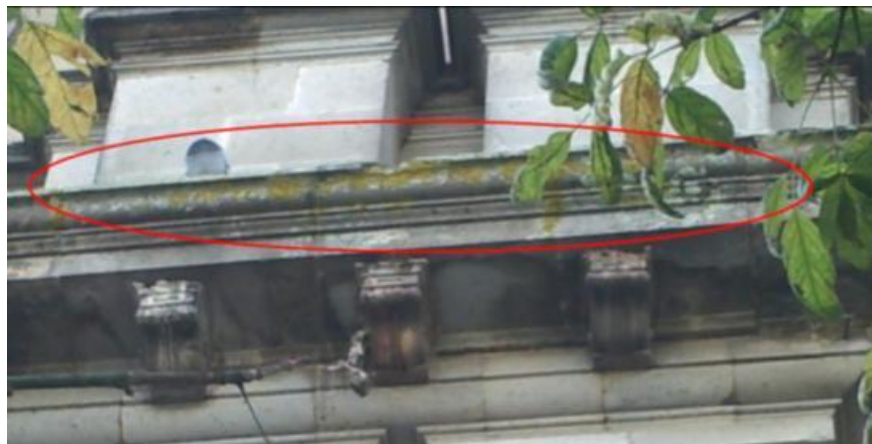
Figura 302 Destrucción de perfiles
