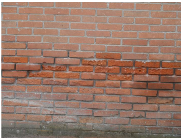
Figura 1 Se puede observar en la parte inferior izquierda una línea ondulada, que representa el avance de humedad capilar ascendente, ha sido variable su altura dependiendo de la variación del nivel freático. Se observa además una franja más o menos delimitada en donde la humedad capilar es de movimiento horizontal.
