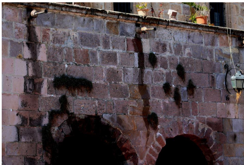
Figura 151 Cantera rosa, Centro Histórico de Morelia. Humedad descendente debida a los escurrimientos de agua. (Eduardo Montes)
