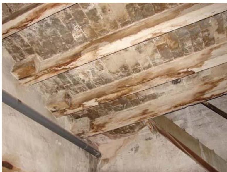
Figura 180 Humedad en techos falsos (ITE)
