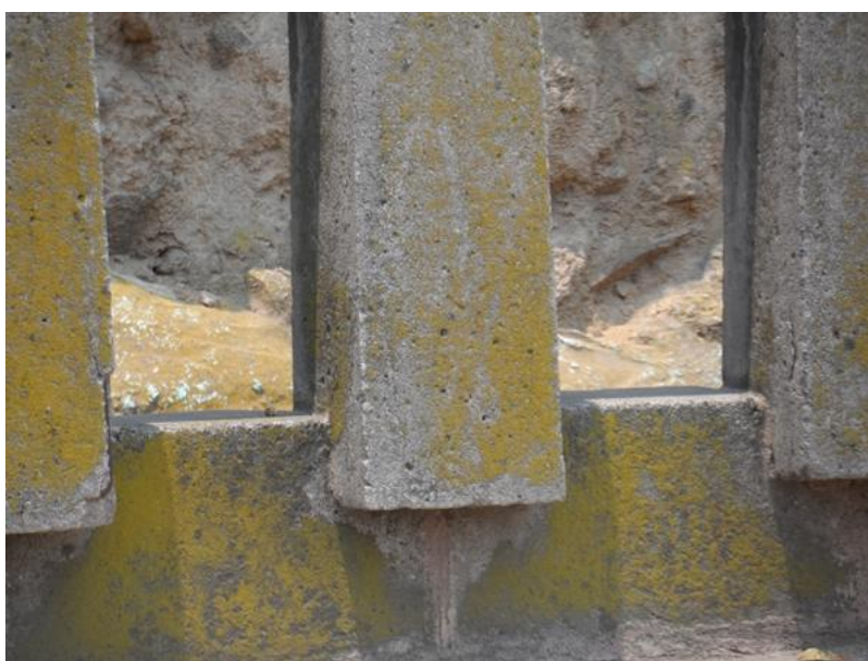
Figura 221 Rhyzocarpon sobre concreto armado Fuente de Los Jaguares Centro Histórico de Toluca
