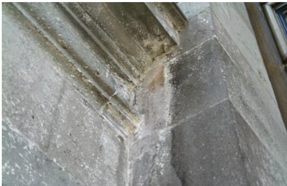
Figura 245 Puerta de la entrada principal. Acumulación de suciedad
