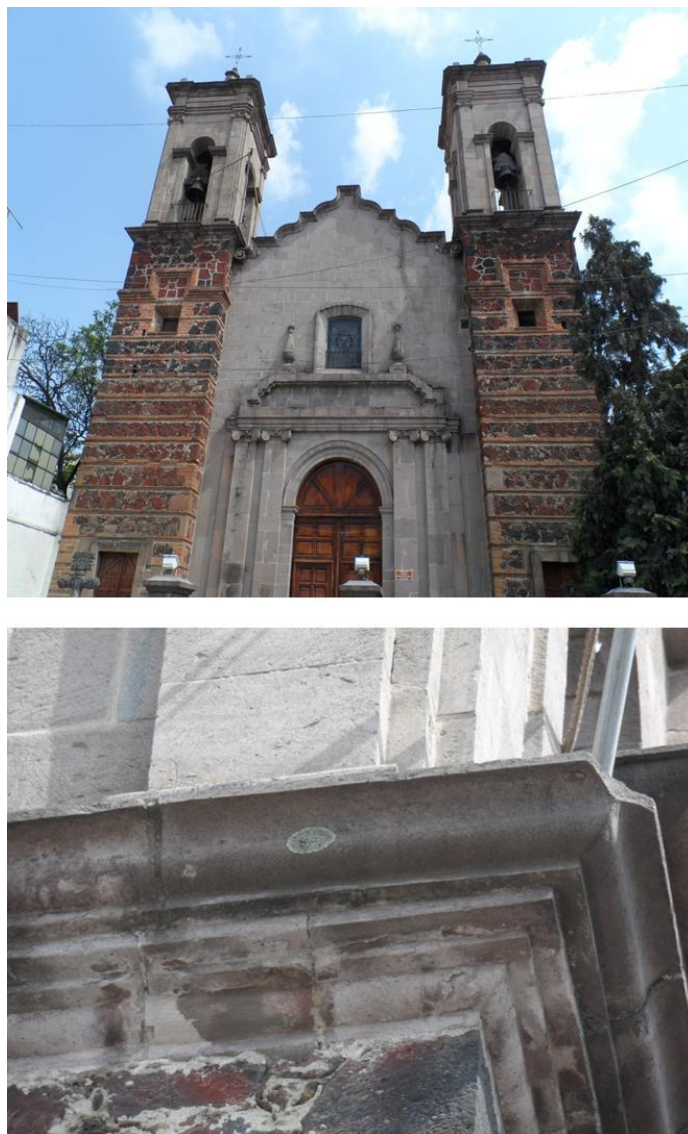
Figura 193 Iglesia Franciscana Lerma. Cabecera Municipal Liqueen Lecanora, escurrimientos y fracturamiento con pérdida de masa
